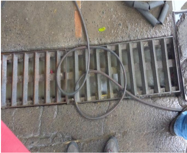
Imagen 33: Rejilla para el lavado de motos
