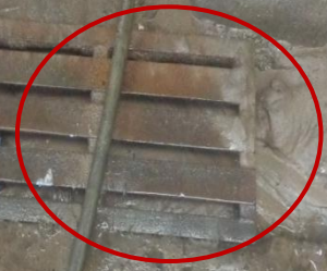
Imagen 30: Rejilla perimetral colmatada
