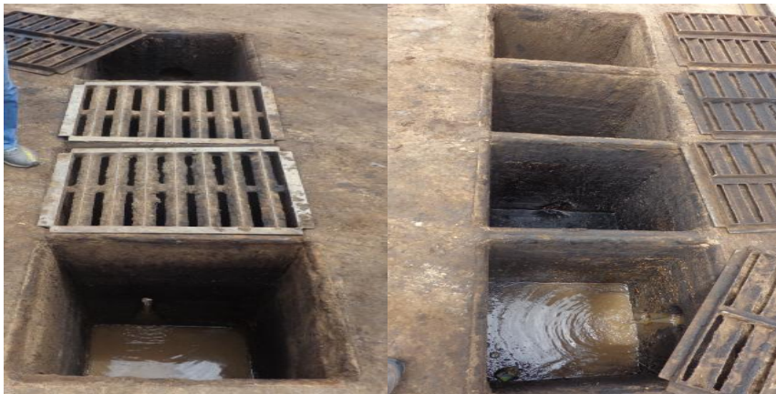
Imagen 65. Estructuras trampa grasa
