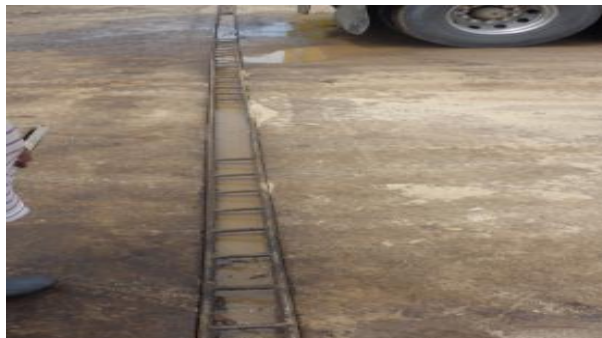
Imagen 63. Estructura de rejilla mal dimensionada
