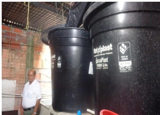
Imagen 102: Tanques de almacenamiento
