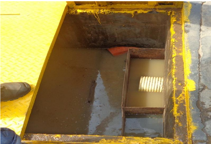
Imagen 39 Estructura trampa grasas
