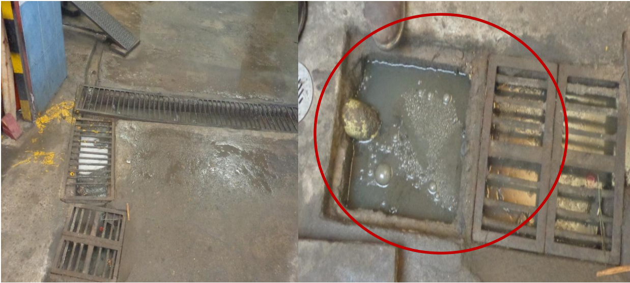
Imagen 42: Rejilla perimetral mal dimensionada Imagen 43: Trampa grasas mal dimensionada
