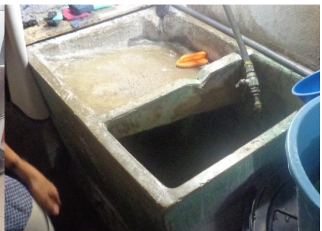
Imagen 97: Tanque de almacenamiento
