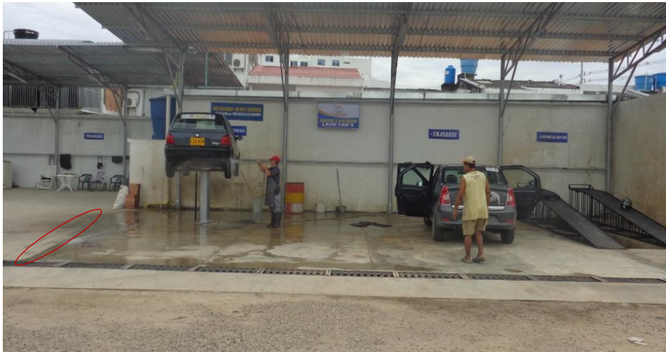
Imagen 1. Rejilla a lo largo del área de lavado, falta rejilla lateral
