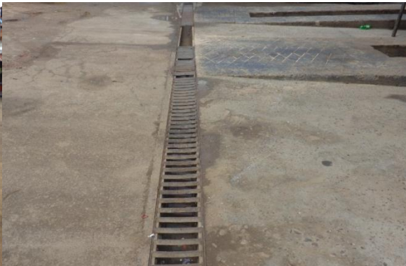
Imagen 62. Falta de barrotes en rejilla
