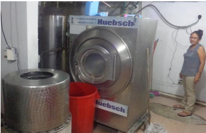
Imagen 94: lavadora y caldera industrial
