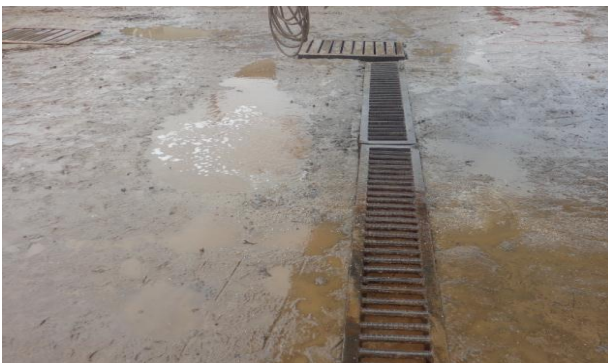
Imagen 54. Rejilla Área de lavado parte posterior lavado
