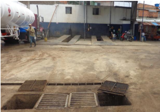
Imagen 61. Estructura de rejilla mal dimensionada
