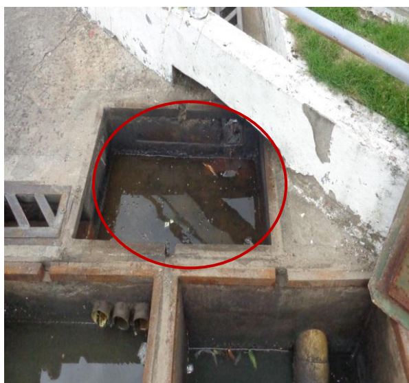
Imagen 135. Caja Trampa grasas y sedimentador
