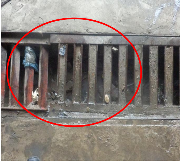
Imagen 16: Residuos sólidos en rejilla
