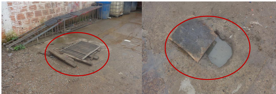
Imagen 117 Estructura trampa grasas rudimentaria
