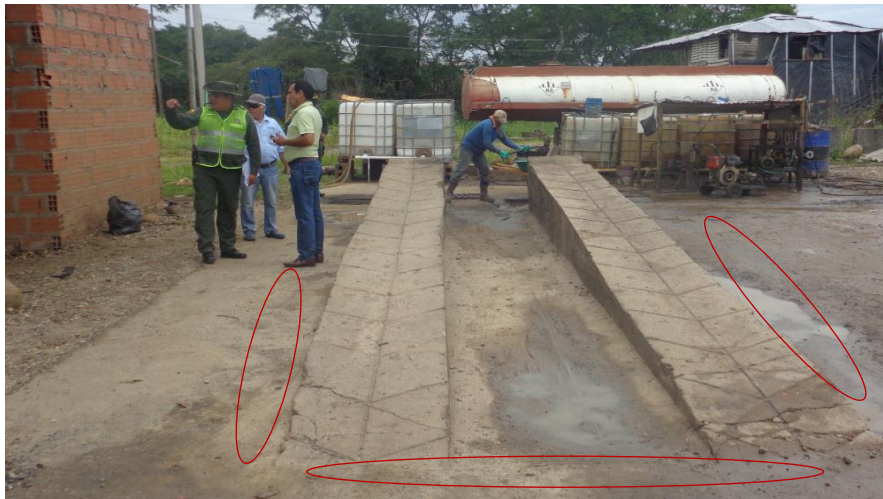
Imagen 58. No se evidencia rejilla perimetral
