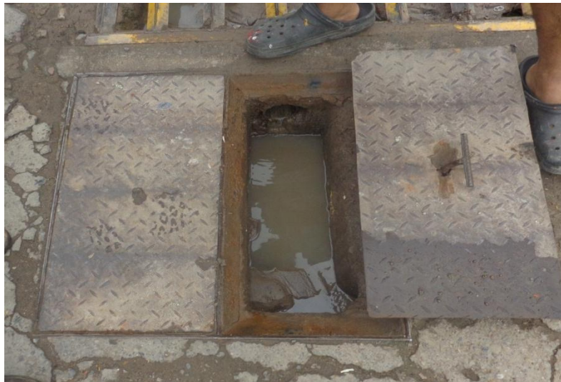
Imagen 35: Caja de inspección
