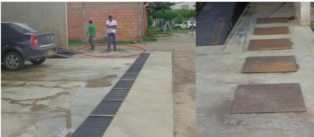
Imagen 2. Estructuras filtrantes, no se evidencia función alguna
