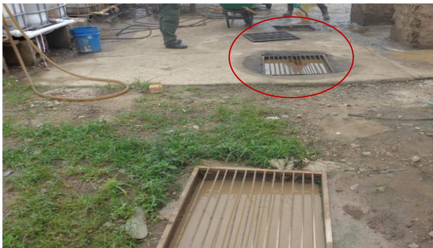
Imagen 59. Estructuras tipo trampa de grasas, pero no cumplen dicha función
