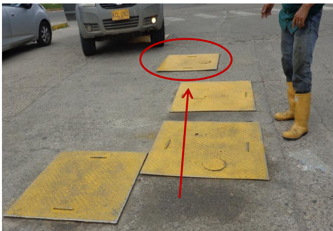
Imagen 75. Trampas de grasa no secuenciales
