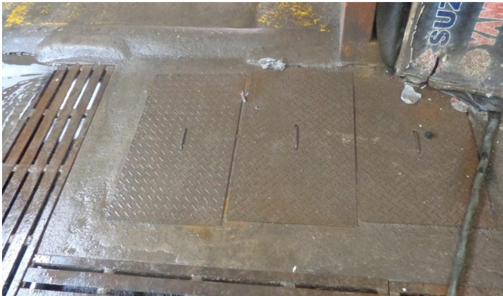
Imagen 31. Estructura nueva de trampa grasas
