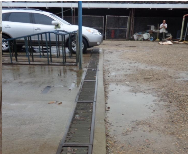
Imagen 50. Rejilla perimetral vista lateral
