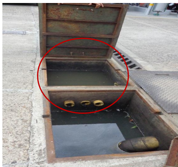
Imagen 136. Caja de inspección recolectora
