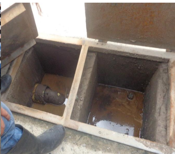
Imagen 5: Salida trampa grasas a alcantarillado
