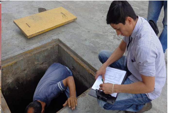
Imagen 38 Revisión caja de aforo
