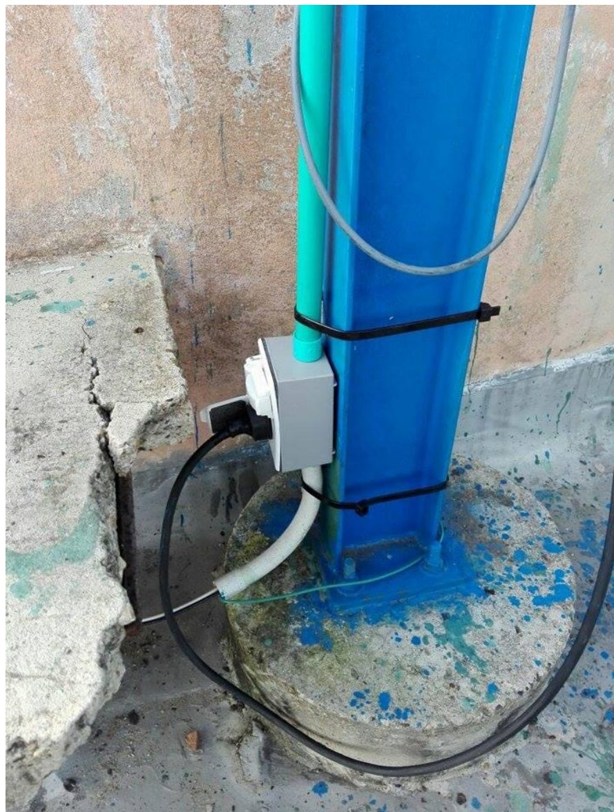
Figura 18. Instalación eléctrica estación Bocana
