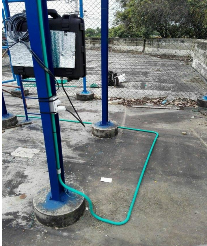
Figura 17. Instalación eléctrica estación Policía
