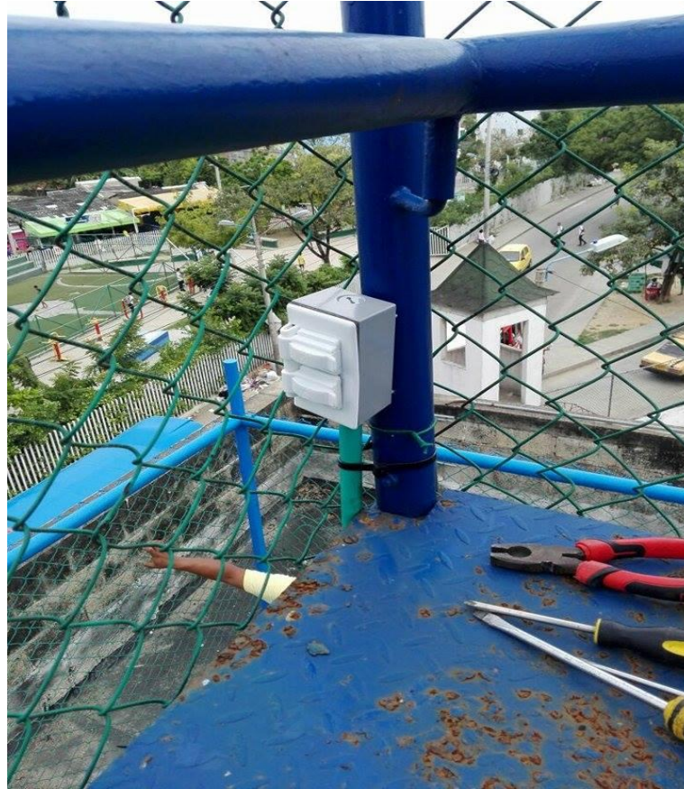
Figura 15. Instalación eléctrica estación base naval
