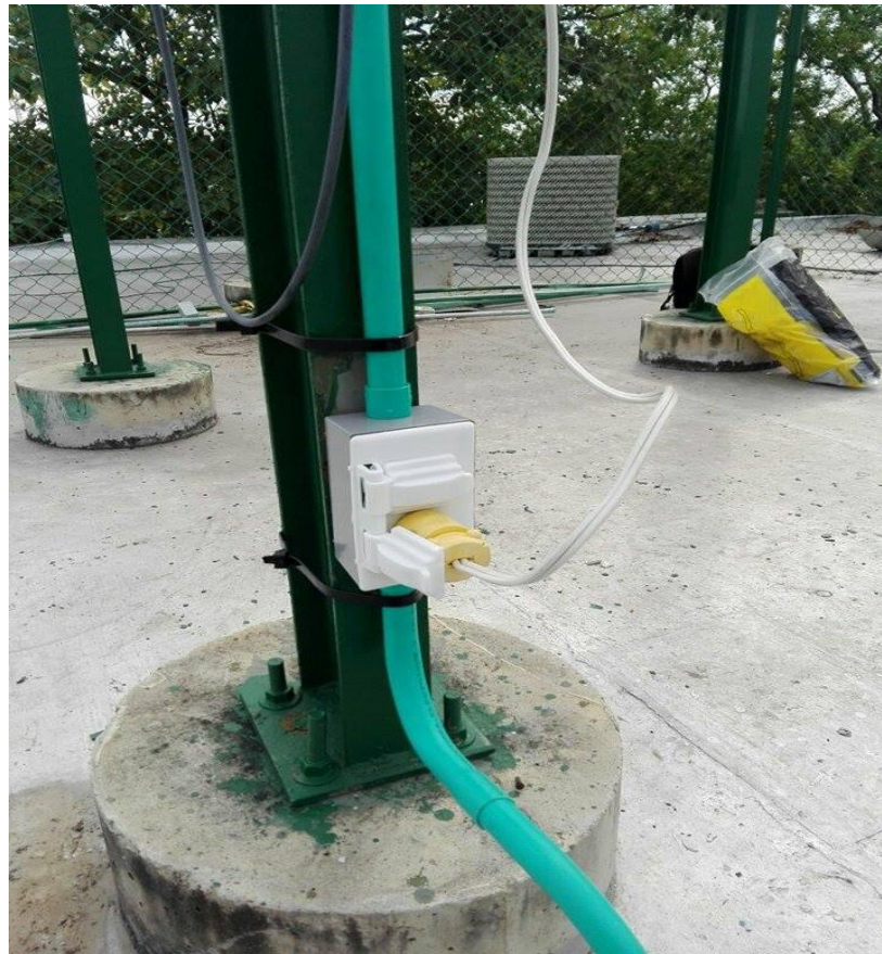
Figura 16. Instalación eléctrica estación Cardique
