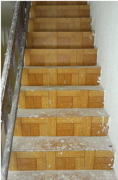
Ilustración 7. Acumulación de Polvos en Escaleras.
