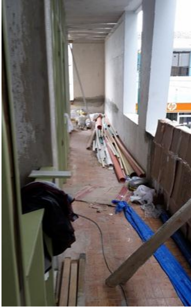
Ilustración 15. Residuos de Tuberías.
