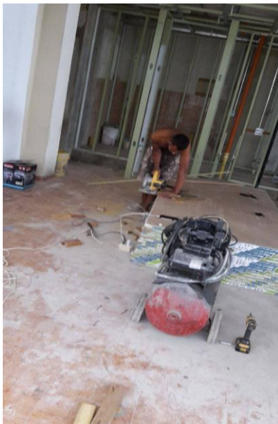
Ilustración 5. Acumulación de Polvos en Pisos.
