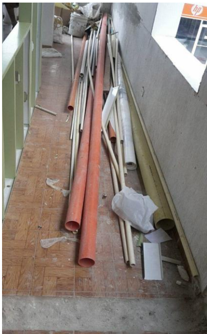
Ilustración 18. Residuos de Tuberías.
