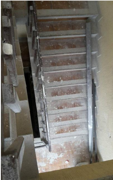
Ilustración 8. Acumulación de Polvos en Escaleras.
