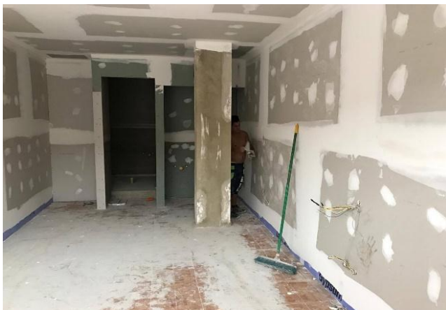
Ilustración 12. Acumulación de Polvos sobre Muros y Pisos.
