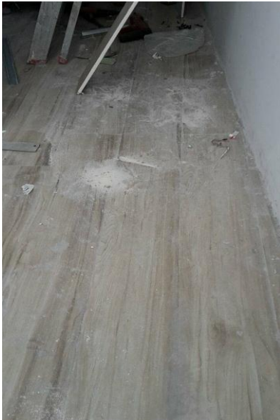
Ilustración 6. Acumulación de Polvos en Pisos.
