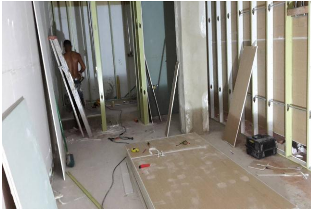
Ilustración 10. Acumulación de Polvos en Material de Trabajo.
