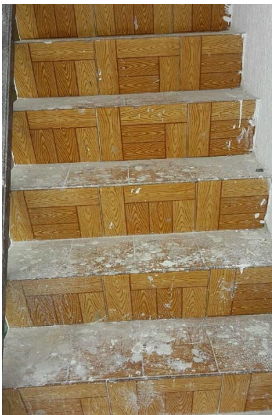
Ilustración 9. Acumulación de Polvos en Escaleras.
