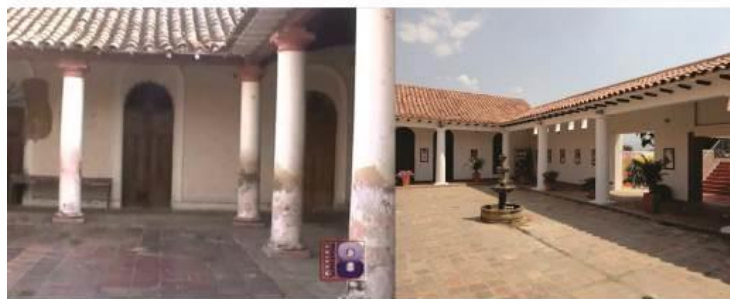
Interior de la casa. Antes y después de su restauración, Actual centro de convivencia ciudadana de Villa del Rosario. Fuente: Youtube: Los Jóvenes hablan de la Casa Hospital Doctor José Jacinto Manrique y Villanoticias.com.
