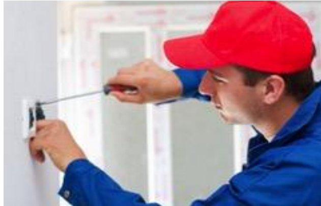
Figura 6. Electricidad Fuente: Susaeta, 2004
