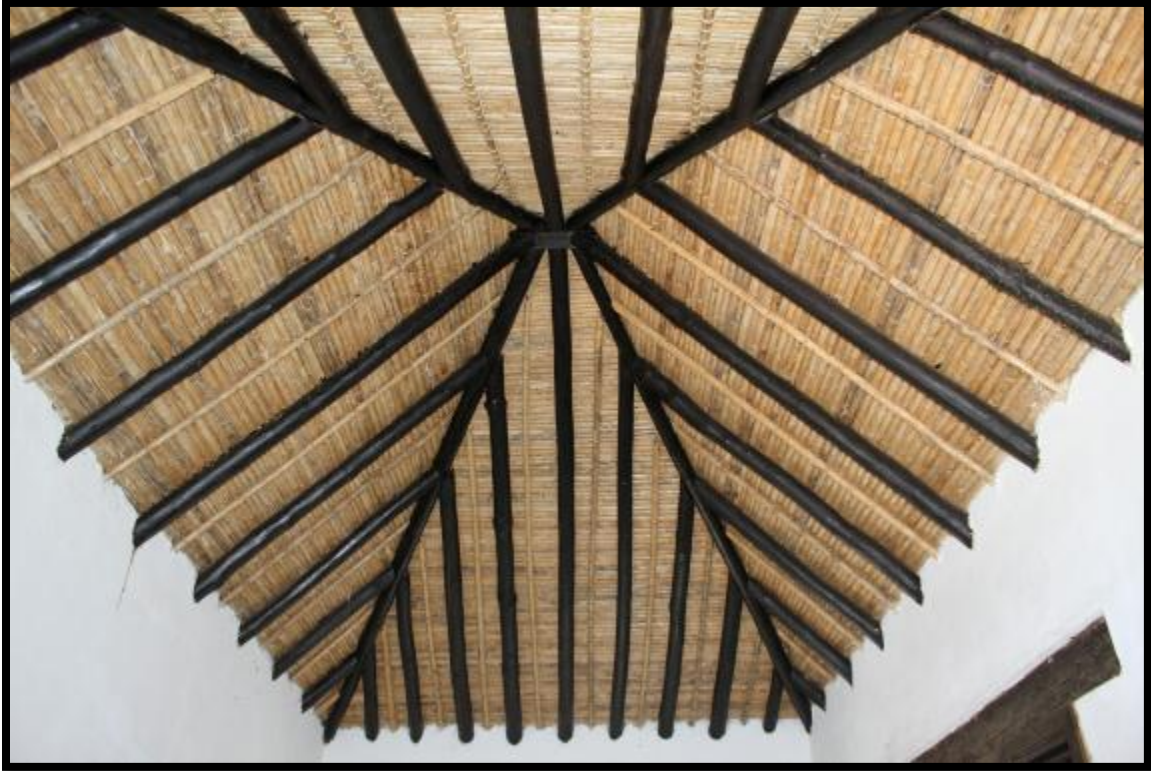
Imagen 24 Además, es apreciable cielos rasos de 3 vertientes sobre espacios completos y sobre los puntos fijos, los cuales presentan construcción independiente, además conservan la materialidad y las técnicas predominantes en la estructura de cubierta.
