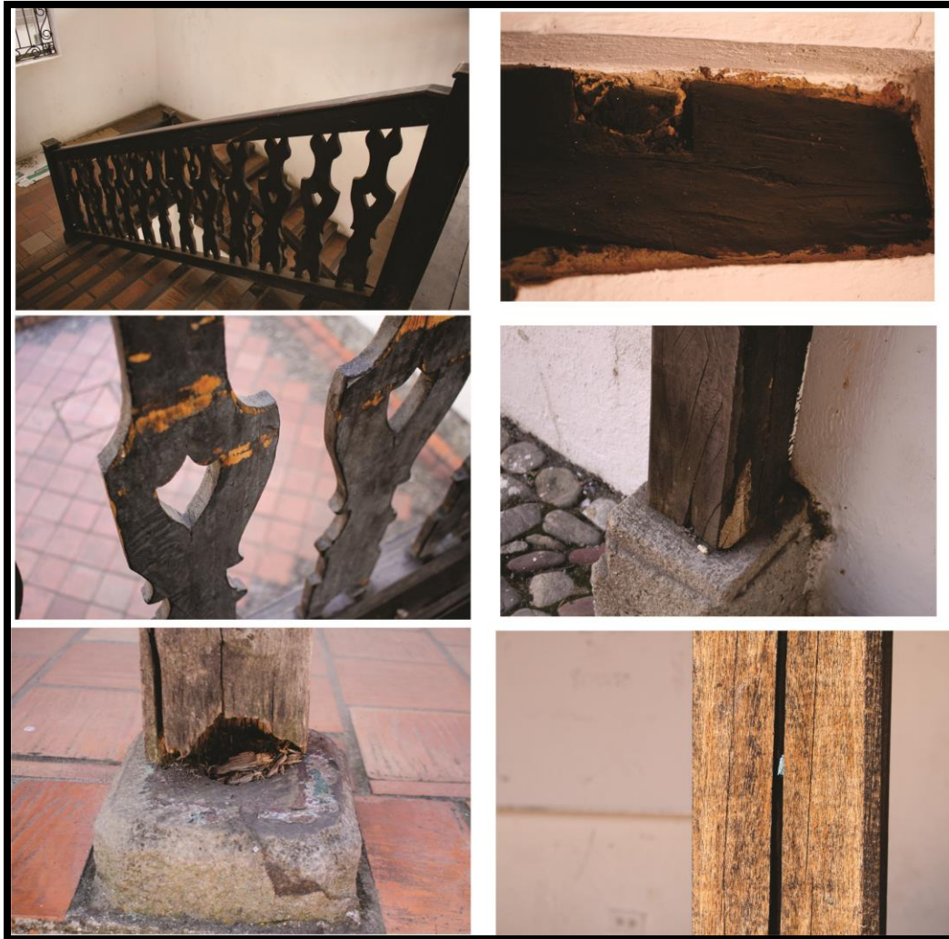
Imagen 18. Las principales consecuencias patológicas de la madera correspondiente a la balconada se deben a su exposición y constante uso evidenciando gasto del material original pérdida de los revestimientos protectores erosiones del material y agrietamientos por compresión.
