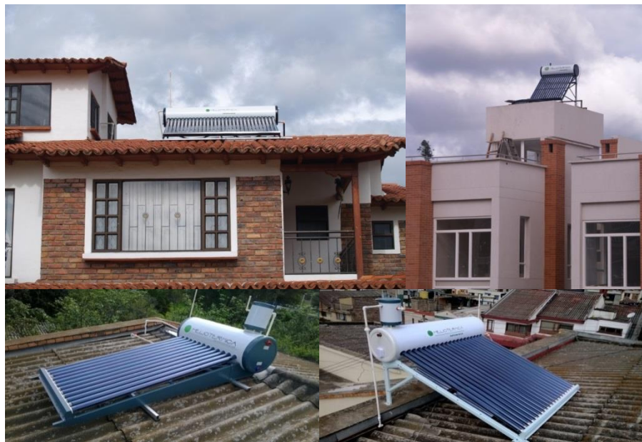
Ilustración 37: Sistemas instalados en Duitama Boyacá.
