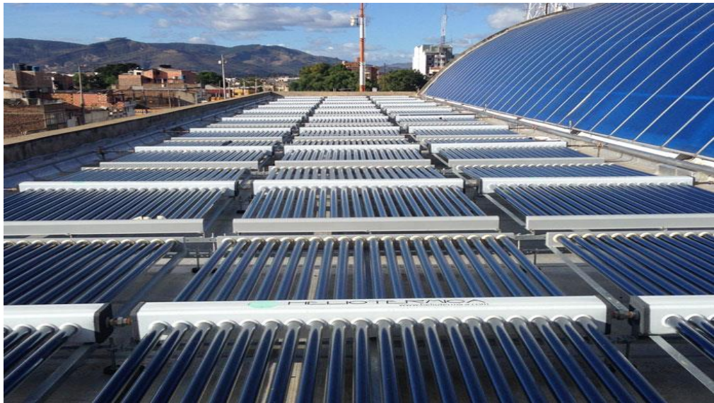
Ilustración 35. . Sistema de colectores solares para calentar 300.000 litros de agua en una piscina semi-olímpica en Sogamoso Boyacá, año 2014 instalado por Heliotermica.
