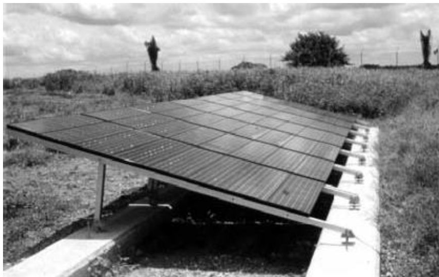
Ilustración 33. Sistema fotovoltaico de 3.4 kwp, del Oleoducto Caño Limoncoveñas, en operación desde hace 20 años, instalado por Centro las Gaviotas Colombia.
