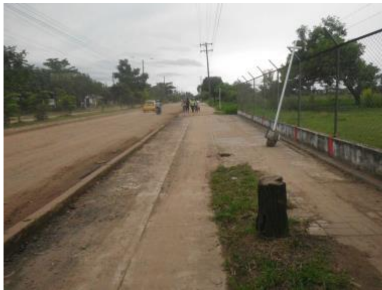
Imagen 26: Afectación del lote Barrio Villa Andrea Carrera 20 Calle 24.
