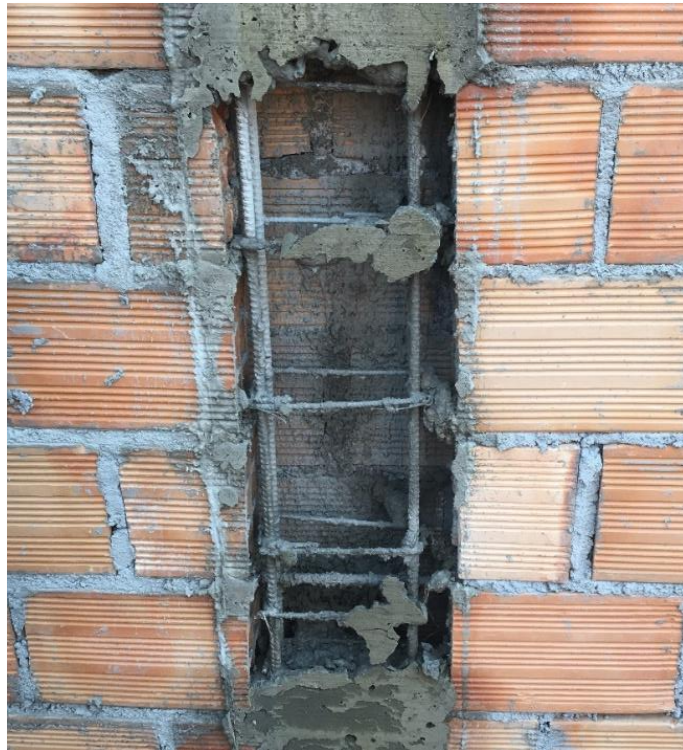
Figura 27. Mal vibrado del concreto o ausencia de vibrado Fuente: Propia
