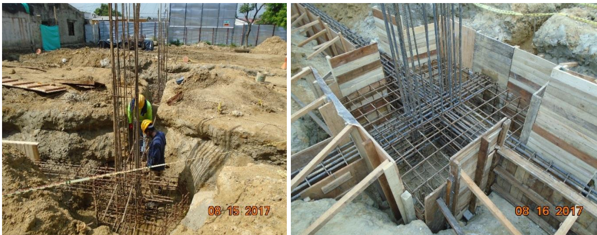
Figura 14.. Figuración y colocación de acero de refuerzo para las vigas y zapatas de cimentación
