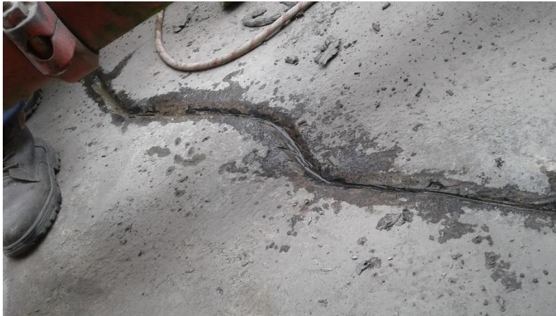
Imagen 25 Fisuras encontradas en las placas. Fuente: Autor
