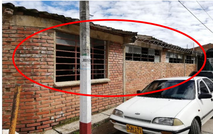
Ilustración 7 Fotografía deterioro fachada este antiguo salón cultural
