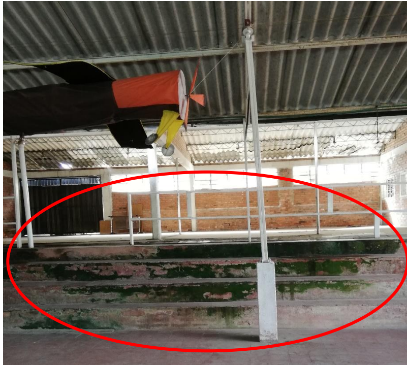
Ilustración 9 Fotografía humedad en gradería
