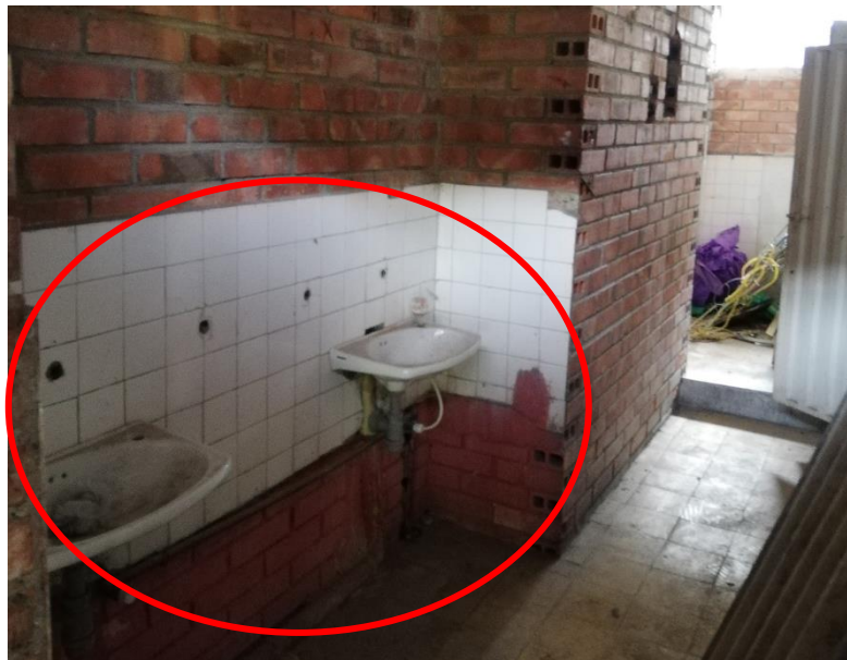
Ilustración 10 Fotografía mal estado batería sanitaria
