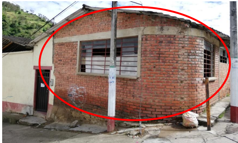
Ilustración 8 Fotografía deterioro fachada sur antiguo salón cultural
