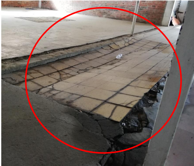
Ilustración 11 Fotografía hundimiento en pisos
