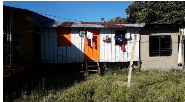
imagen 44-vivienda 3 en zona de riesgo por cota de inundación-fuente autor
