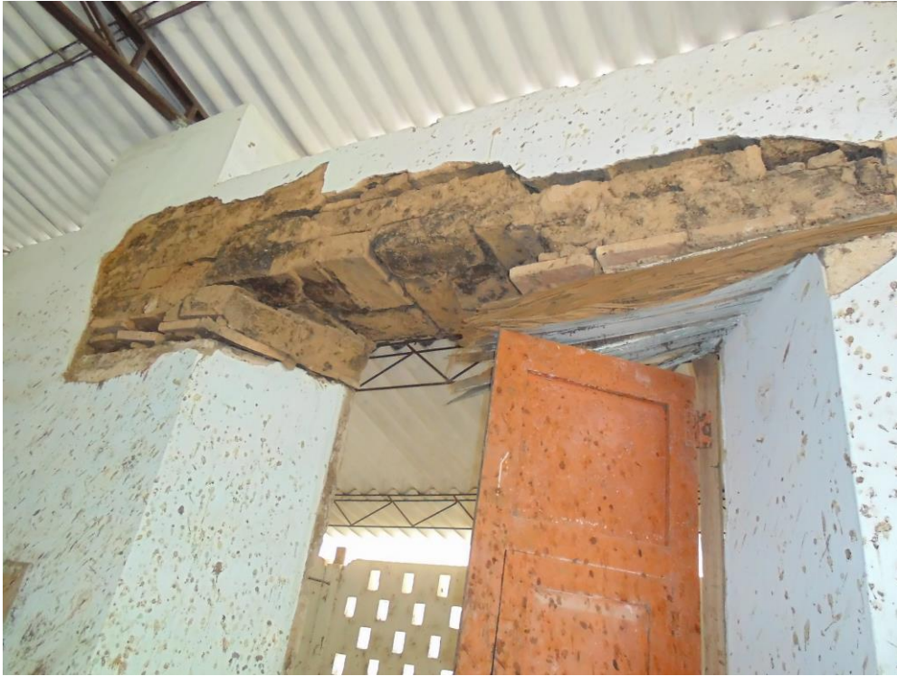
Imagen N° 26: Estación de Puerto Villamizar - Ejemplo del deterioro de los dinteles y estado de los bloques de adobe.
