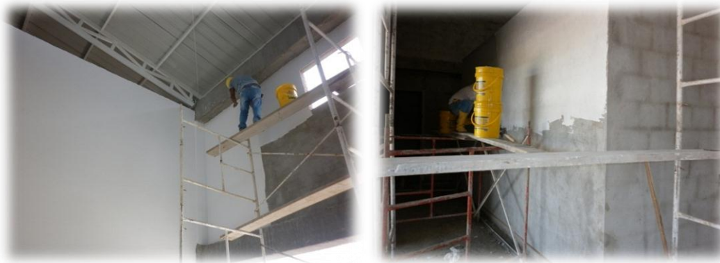
Figura 18. Estuco impermeabilizado para muros interiores de la planta.
