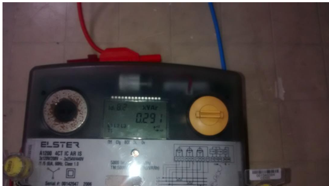
Figura 37. Imágenes de los Kvar del motor analizado. Fuente: El Autor
