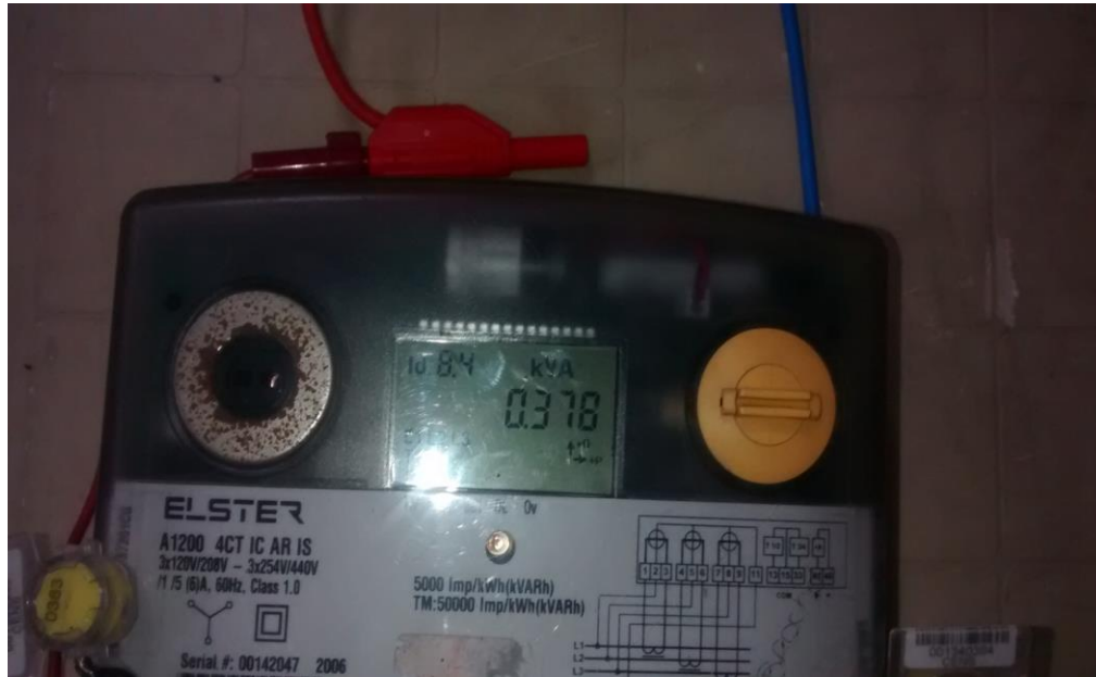
Figura 36. Imágenes del medidor de energía del O.R. Muestra los Kva del motor analizado.
