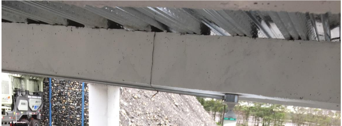
Ilustración 88. Viga luego de ser intervenida. Fuente. Autor
