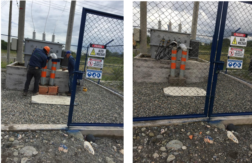
Ilustración 46. Estado actual subestación eléctrica. Fuente. Autor
