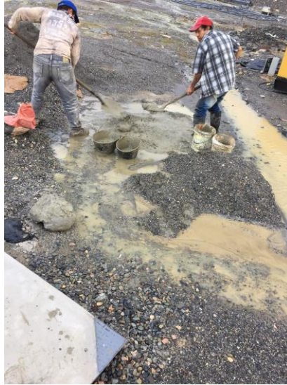
Ilustración 89. Mezcla antes de mi intervención. Fuente. Autor
