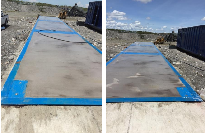
Ilustración 63. Fraguados al concreto. Fuente. Autor
