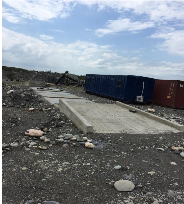
Ilustración 29. Estructura principal de la báscula camionera.
