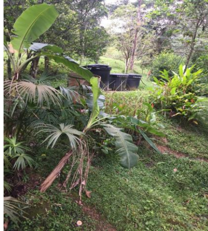
Ilustración 52. Captación de agua.
