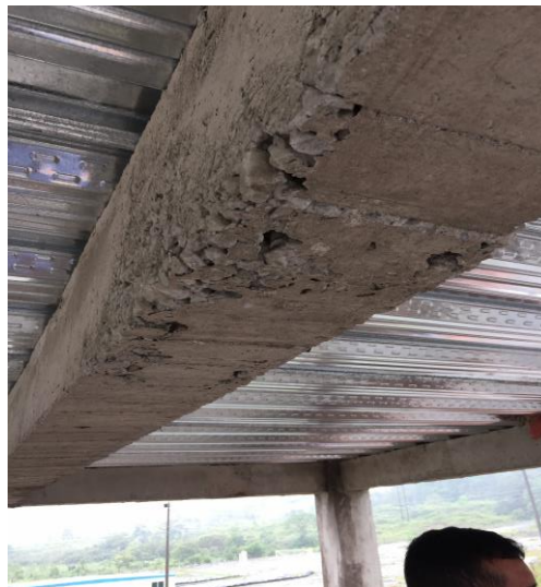
Ilustración 87. Viga con porosidad y refuerzo visible. Fuente. Autor
