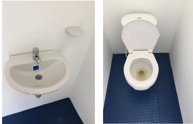
Ilustración 53. Estado baños. Fuente. Autor
