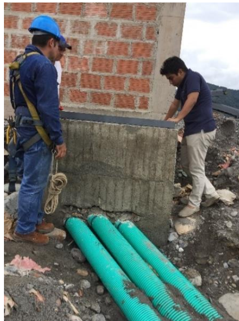
Ilustración 41. Revisión trabajos eléctricos por parte de la EMSA y contratista Camilo Plata. Fuente. Autor
