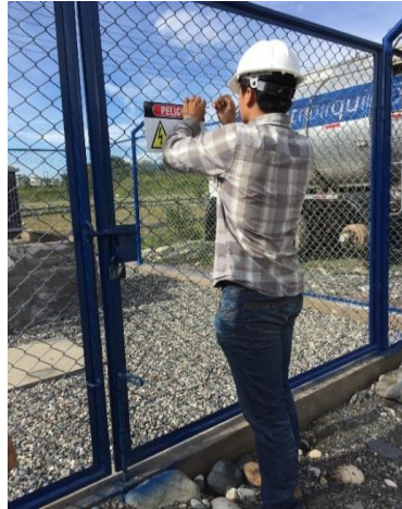
Ilustración 44. Señalización a la subestación por parte del Residente de Obra. Fuente. Autor
