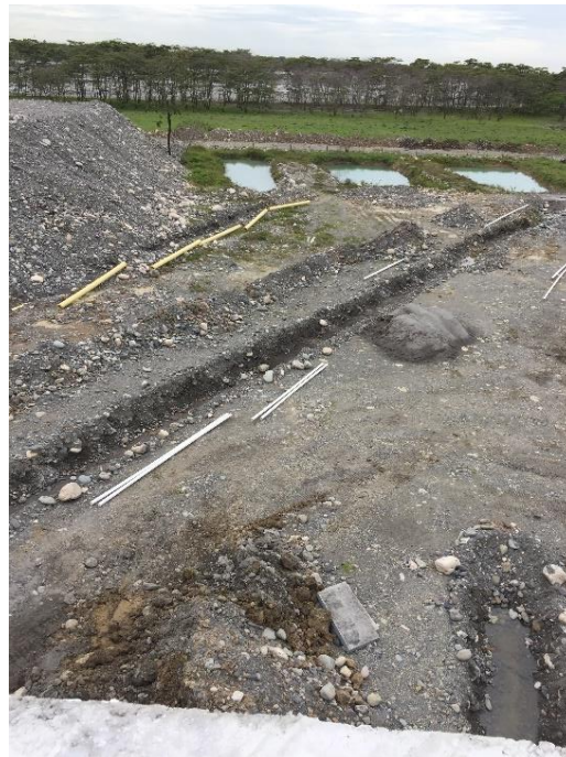
Ilustración 48. Piscinas de sedimentación y Tuberías para la circulación del agua de lavado del material procesado. Fuente. Autor
