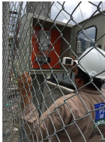
Ilustración 45. Toma de medidas y Certificación del contador eléctrico. Fuente. Autor
