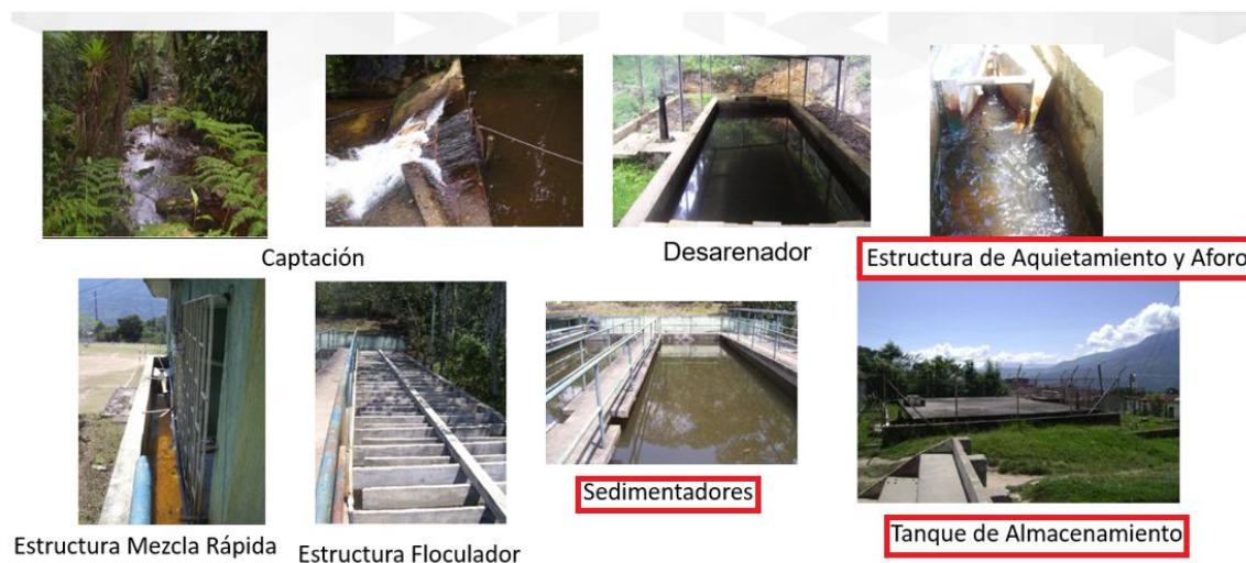
Figura 25. Estructura de la PTAP del municipio de Toledo.
