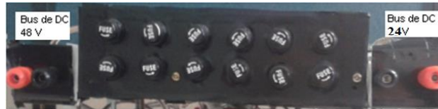
Figura 3.18. Bornes de conexión del bus de 48V.
