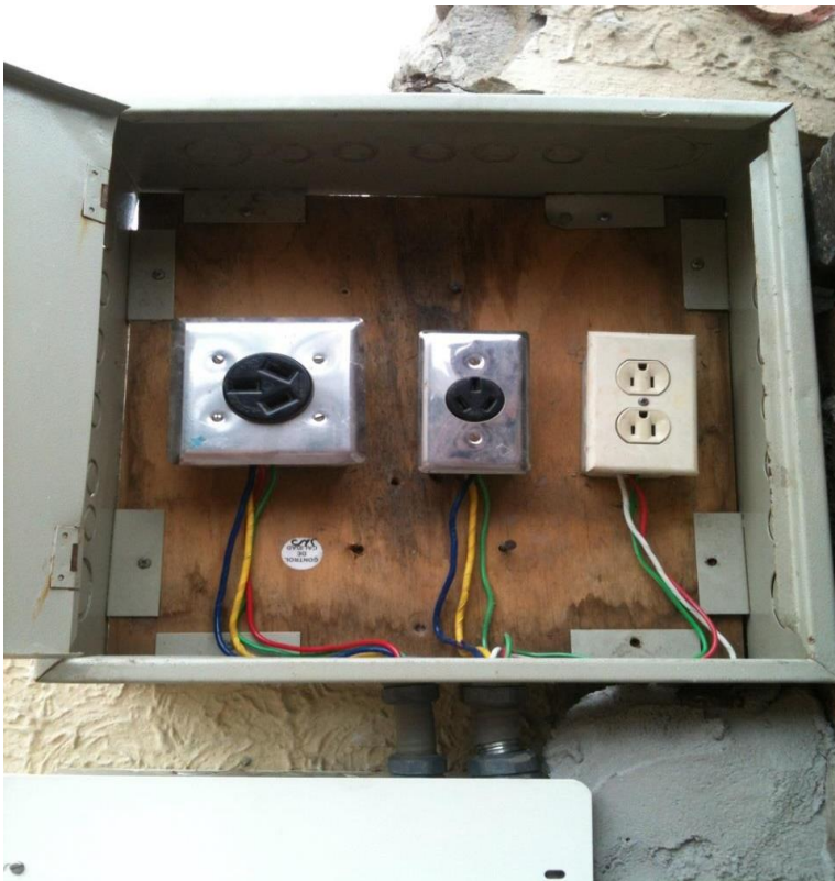
Imagen 14. provisional de acometida eléctrica.
