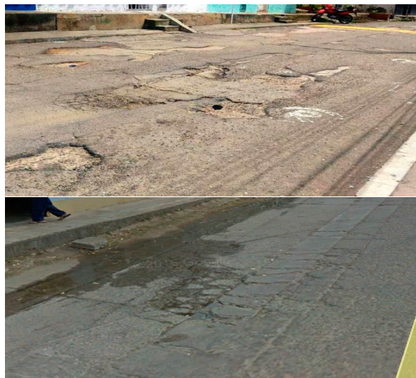
Ilustración 4. Estado de las Vías
