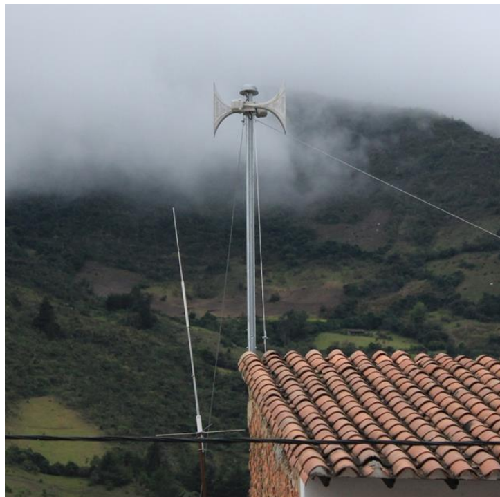
Imagen 22: Sistema de alertamiento acústico Cúcota
