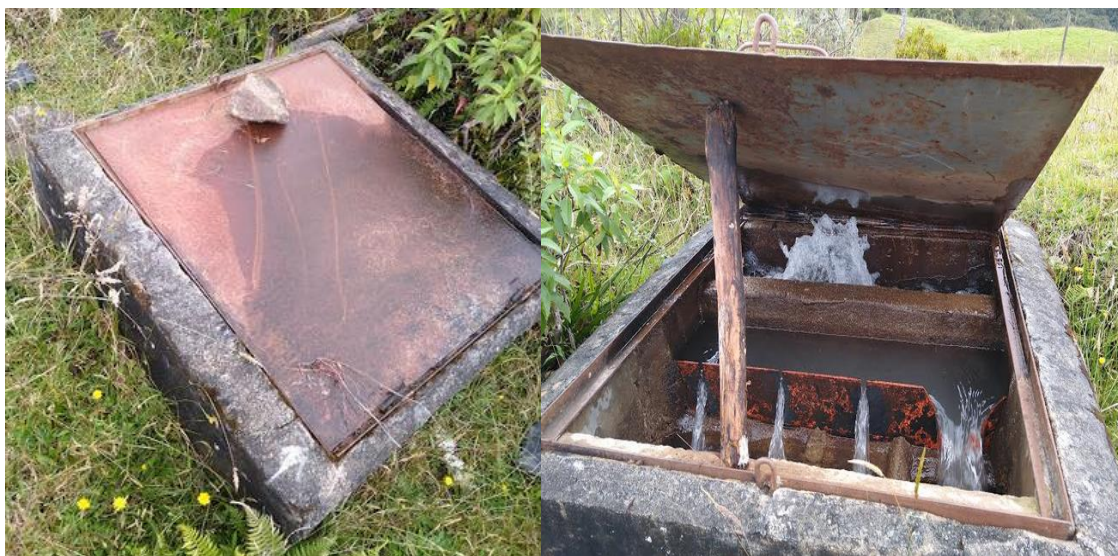
Anexo 9. Estado actual de la tanquilla 3
