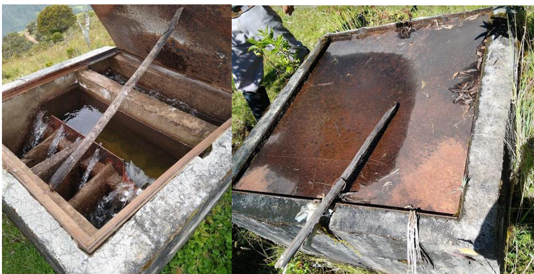
Anexo 15. Estado actual de la tanquilla 9
