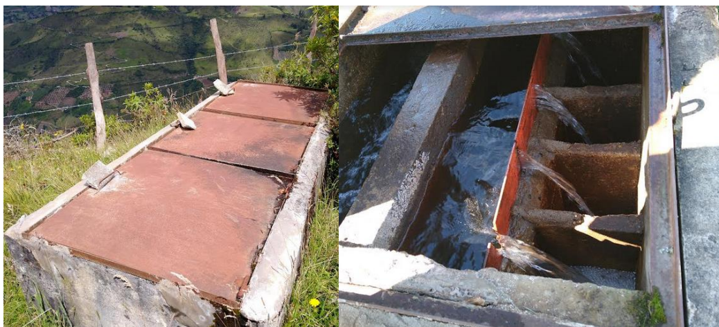
Anexo 11. Estado actual de la tanquilla 5
