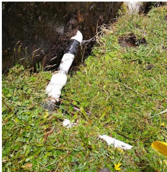
Anexo 7. Fuga en el codo de la tubería a la Tanquilla 1
