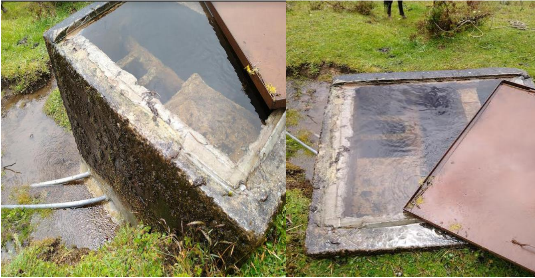
Anexo 6. Estado actual de la Tanquilla 1
