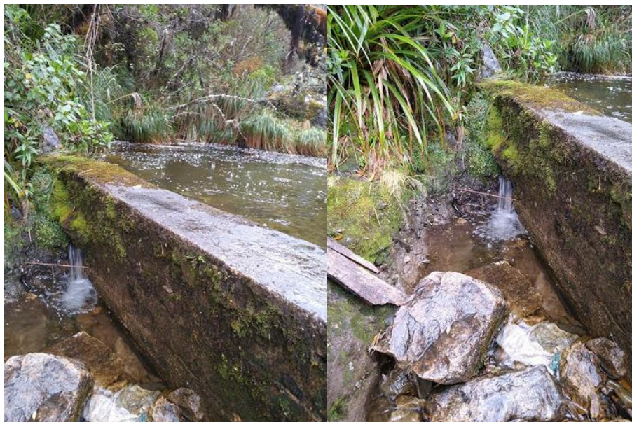
Anexo 2. Ruptura en la boca toma
