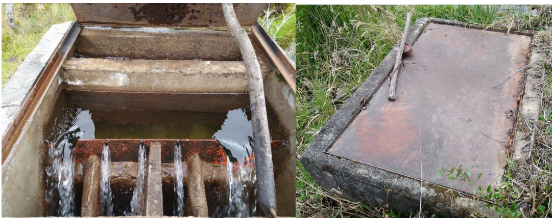
Anexo 16. Estado actual de la tanquilla 10
