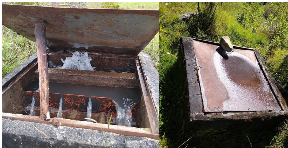
Anexo 14. Estado actual de la tanquilla 8
