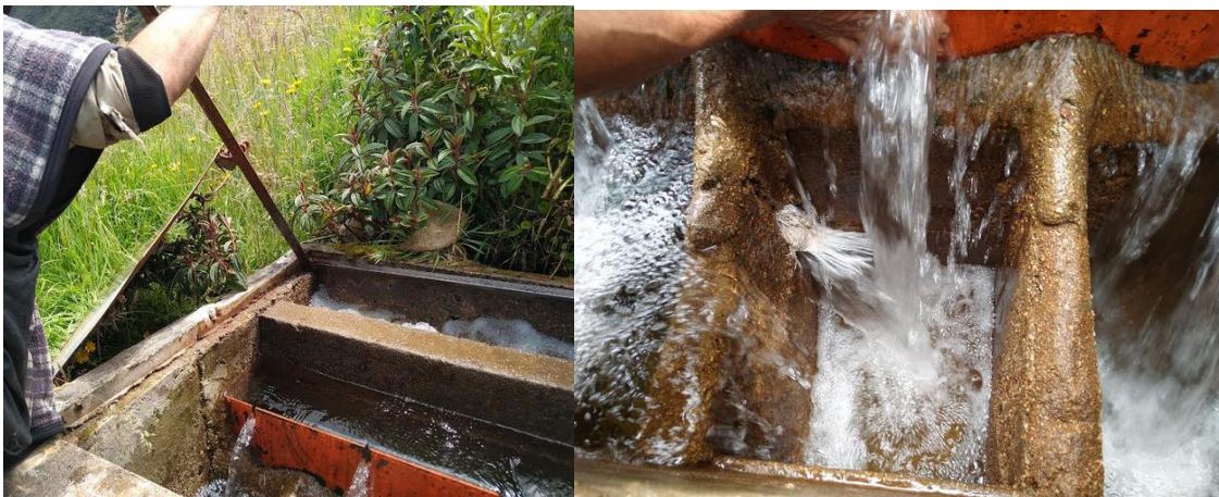
Anexo 10. Estado actual de la tanquilla 4
