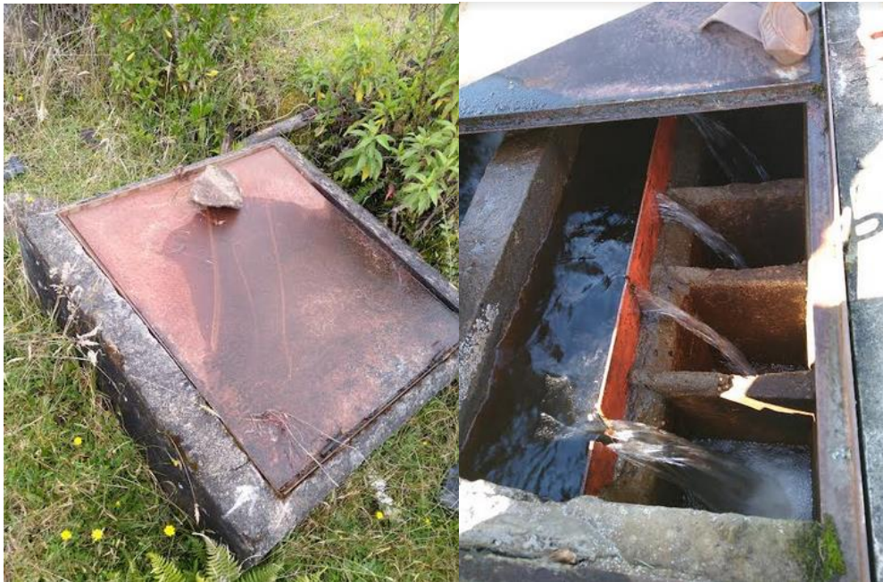
Anexo 13. Estado actual de la tanquilla 7
