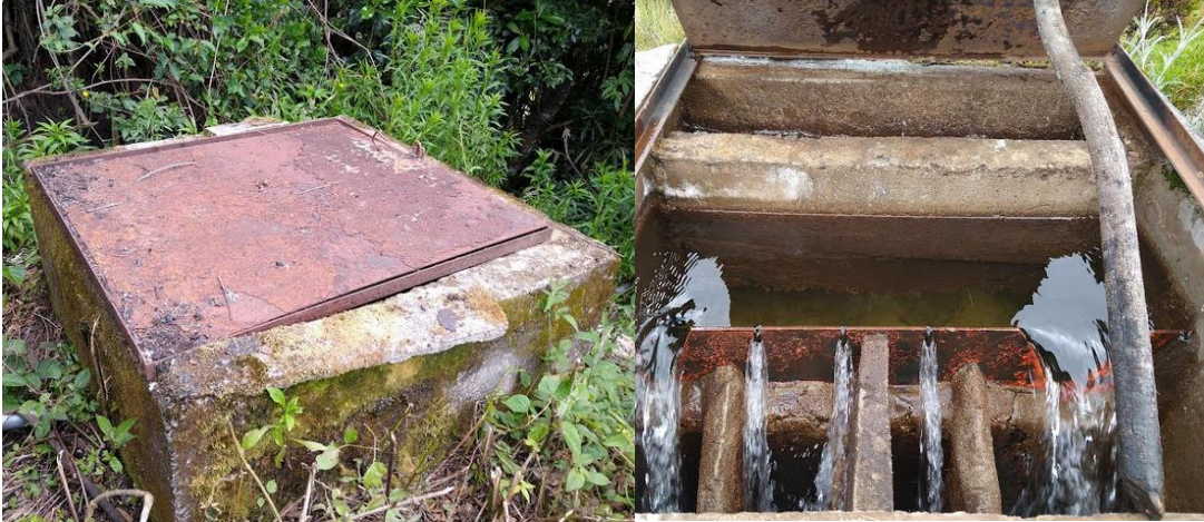
Anexo 12. Estado actual de la tanquilla 6
