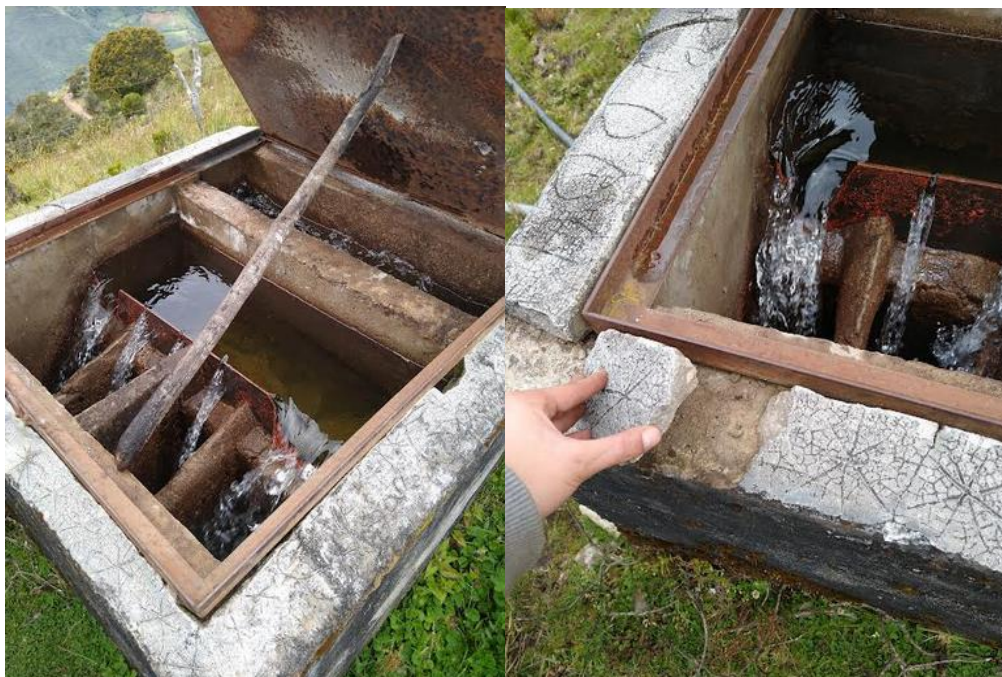
Anexo 8. Estado actual de la Tanquilla 2
