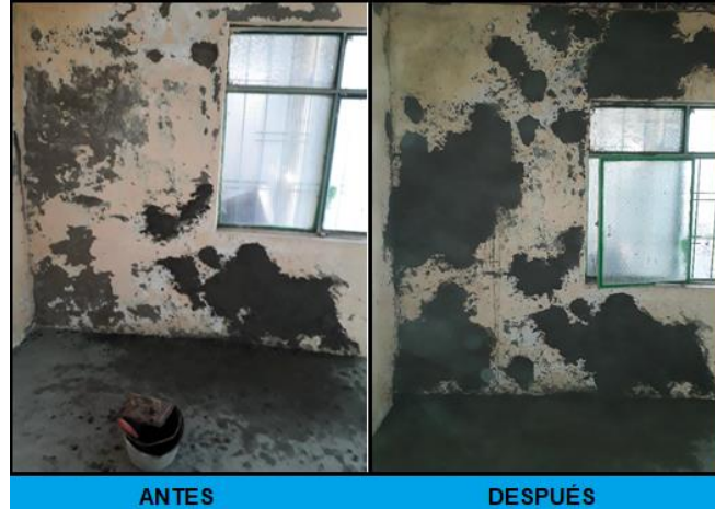
Ilustración 11: antes y después de pared con humedad y deterioro. (elaboración propia).
