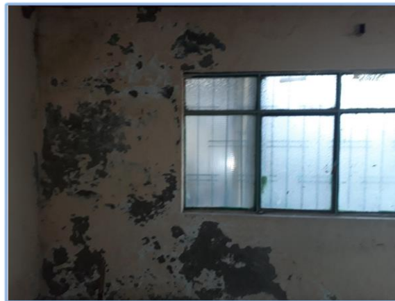
Ilustración 9: humedad y deterioro estructural encontrado en una de las paredes. (elaboración propia).
