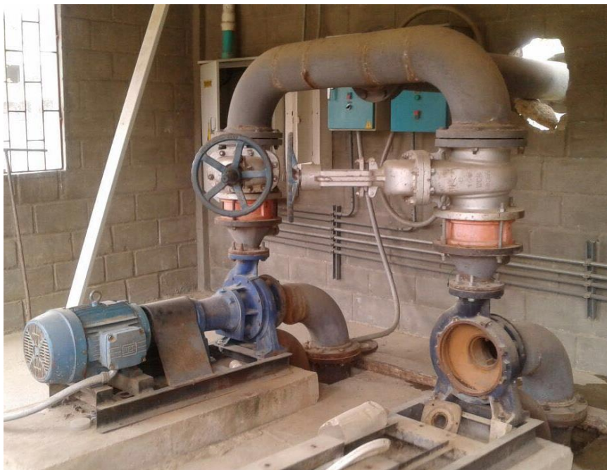
Fig.14 Estación de bombeo
