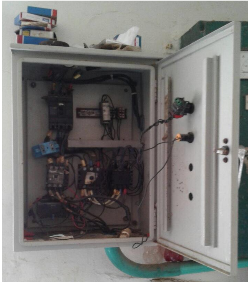
Fig.12, Tablero de mando
