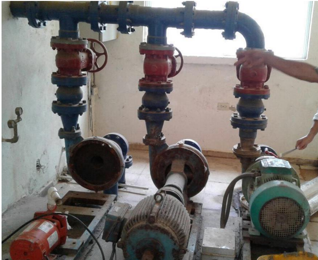
Fig. 11, Motobombas del cuarto de control
