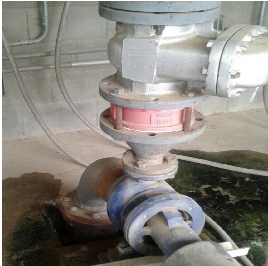
Fig. 16 Conexiones de las motobombas con los pozos
