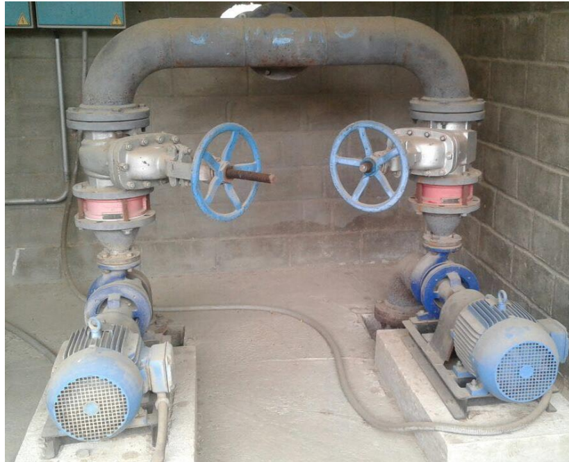
Fig. 15 Estaciones de bombeo
