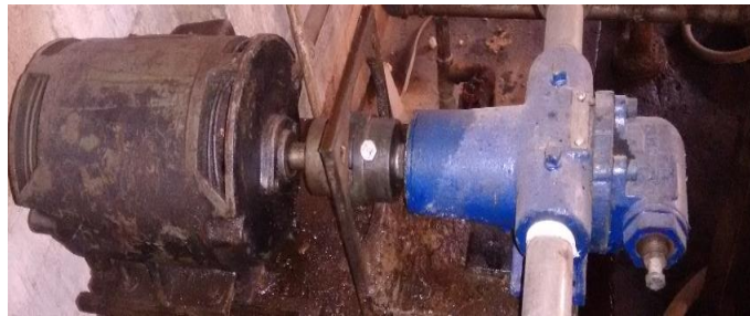
Figura 3. Bomba de filtrado.
