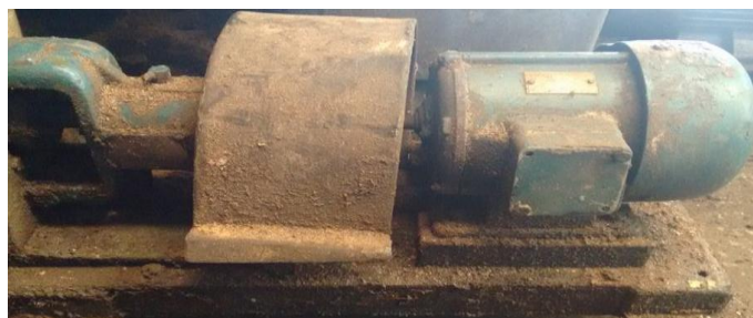
Figura 9. Bomba de llenado.
