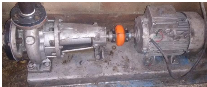
Figura 1. Bomba de llenado.
