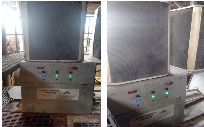
Figura 8. Chiller de refrigeración.
