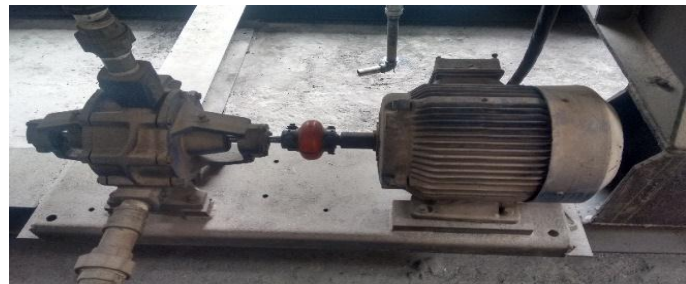
Figura 14. Bomba de llenado.
