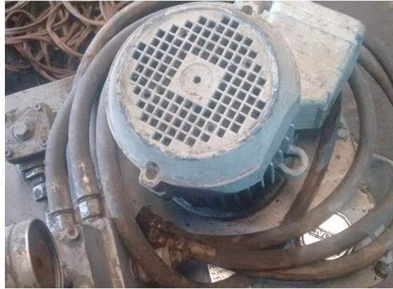
Figura 17. Bomba de circulación de aceite Hidráulico
