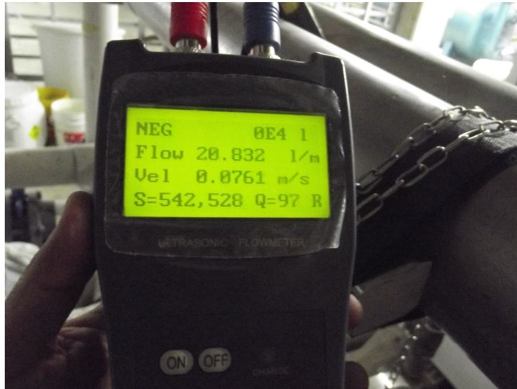
Figura 3-15: Registro de datos del caudal en la tubería. Autor
