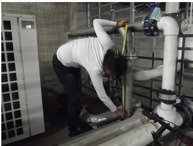
Figura 3-13: Medición longitud de tuberías en el sótano del Centro Urbano Recreacional Infantil. Autor
