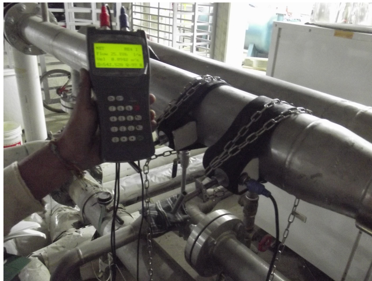
Figura 3-16: Registro de datos del caudal en la tubería. Autor
