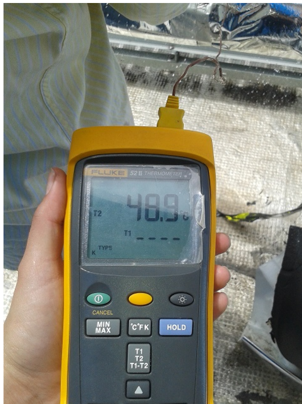
Figura 3-14: Medición de temperaturas en la tubería del Centro Urbano Recreacional Infantil. Autor
