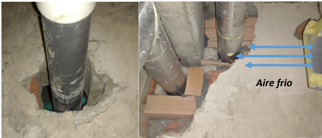
Figura 17. Las habitaciones no tienen la suficiente estanqueidad como para evitar la filtración de aire hacia el cielo raso del pasillo.
