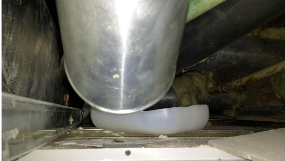
Figura 18. Humedad en el cielo por condensación y goteo.
