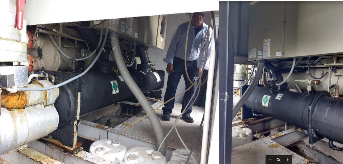
Figura 8. Chiller Hotel Barlovento
