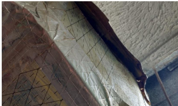
Figura 13. Fuga en el ducto que suministra el aire al 4 piso.
