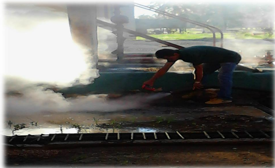
Figura 11: Toma de medida de temperatura del generador Fuente: (Guillermo Cordero)
