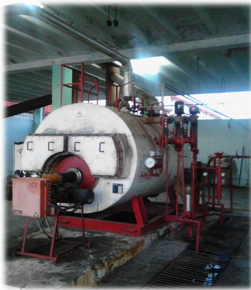
Figura 7: generador de vapor UNICA modelo CMS-C 1100 Fuente: (Guillermo Cordero)
