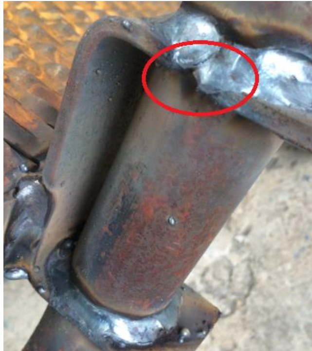
Figura 36. Socavación en soldadura serie 500. (Autor)
