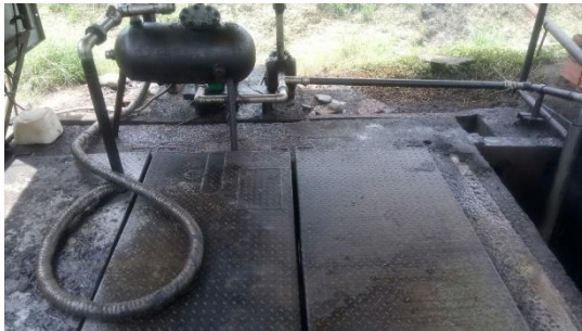
Bombeo de efluentes hacia tanques florentinos
