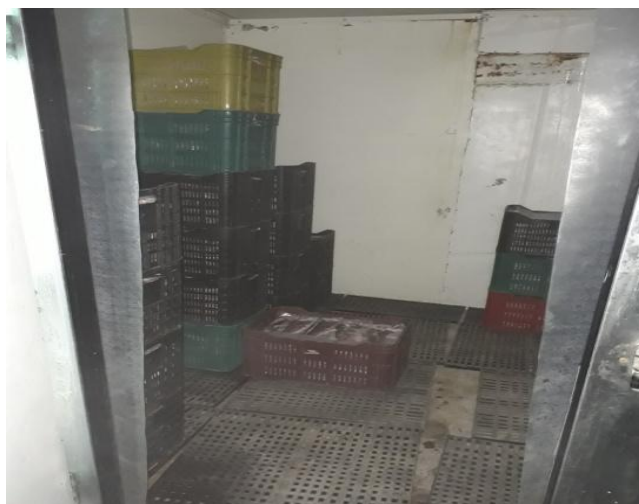
Ilustración 17: cuarto frío, estación piscícola PESQUEMOS. Fuente. Gafaro 2017.
