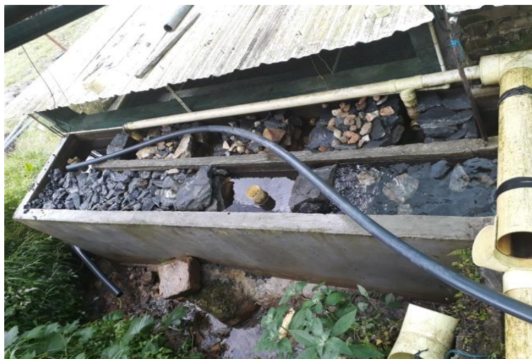
Ilustración 10: Desarenador de La Estación Piscícola. Fuente. Gafaro 2017.
