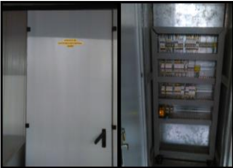
Figura 6. Tablero arrancad TUB02
