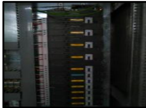
Figura 7. Tablero arrancad TUB03
