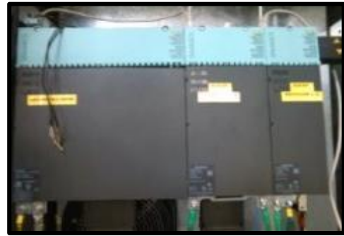
Figura 5. Tablero Arrancador LCL02
