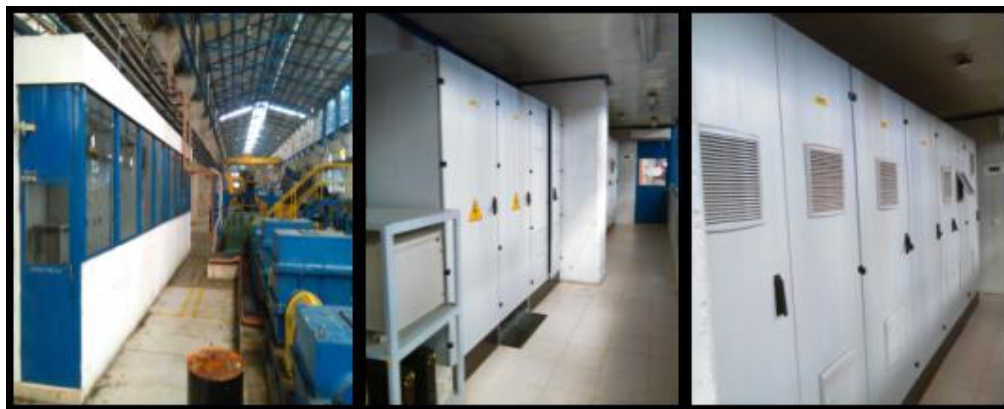
Figura 8. Tableros de control TUB02 y TUB03
