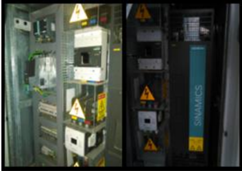
Figura 4. Tablero cortadora LCL02
