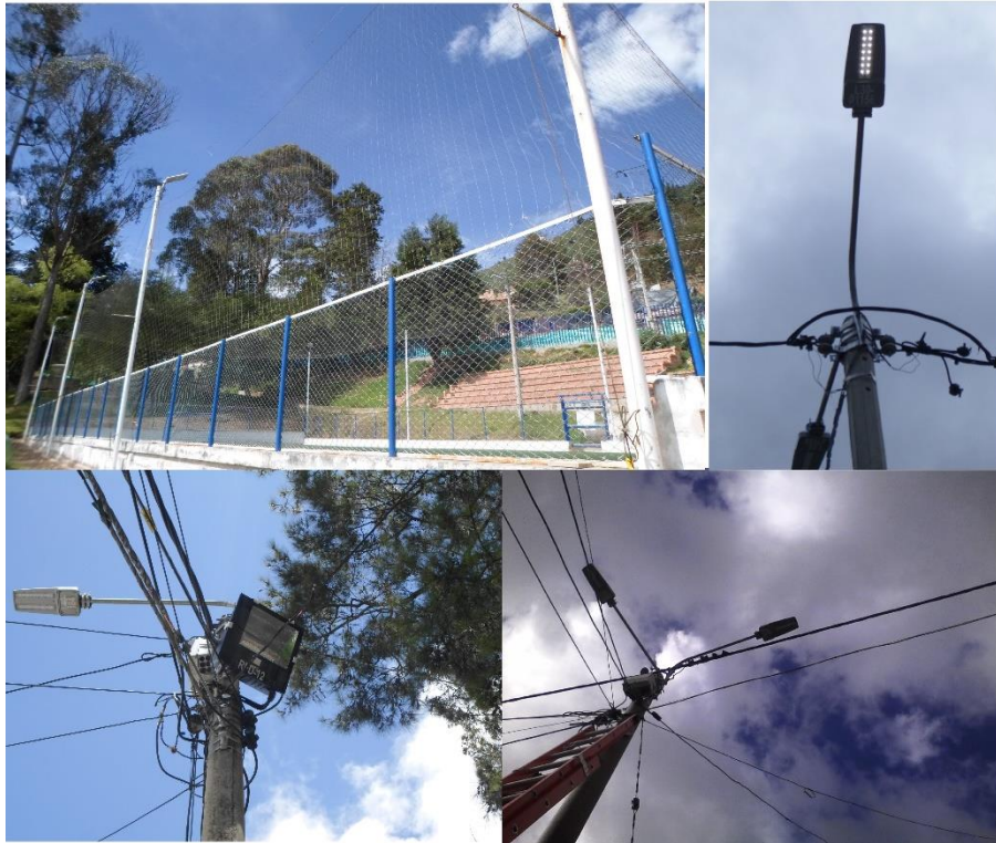
Figura 2. Alumbrado Público AP. Tomada de: Concesión de Alumbrado Público.
