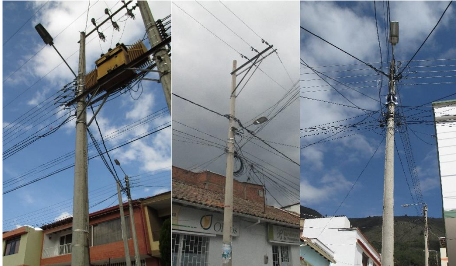
Figura 3. Red Eléctrica de Distribución. Tomada de: Concesión de Alumbrado Público.
