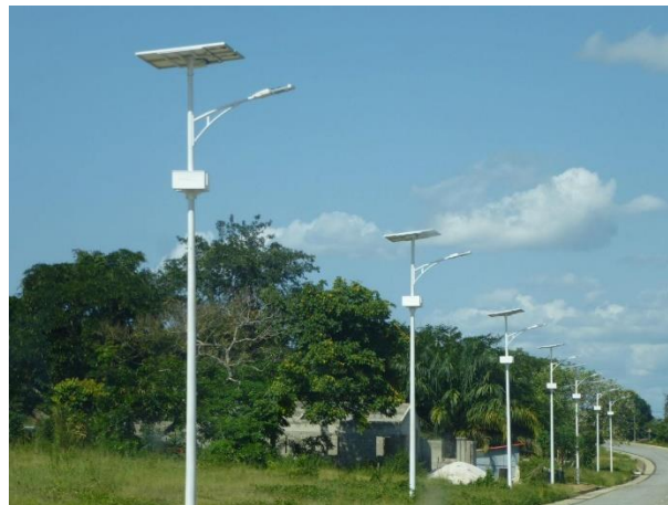
Figura 21. Luminarias Led – Fotovoltaicas.
