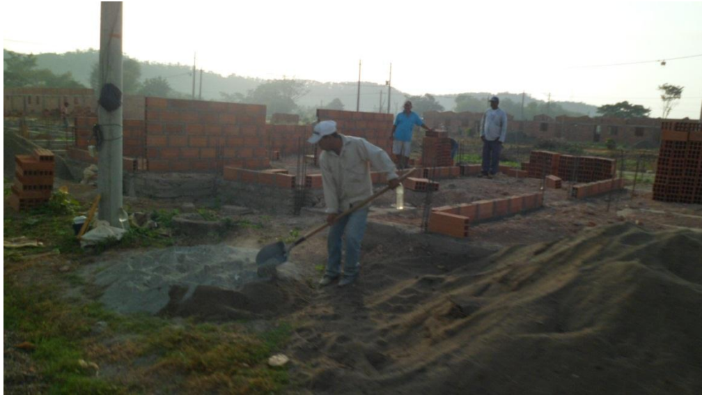
Figura 23. Incumplimiento de la seguridad industrial
