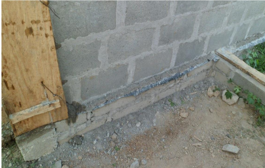
Figura 22. Mal procedimiento en el control de humedad
