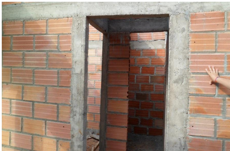
Figura 20. Hormigueo en elementos estructurales
