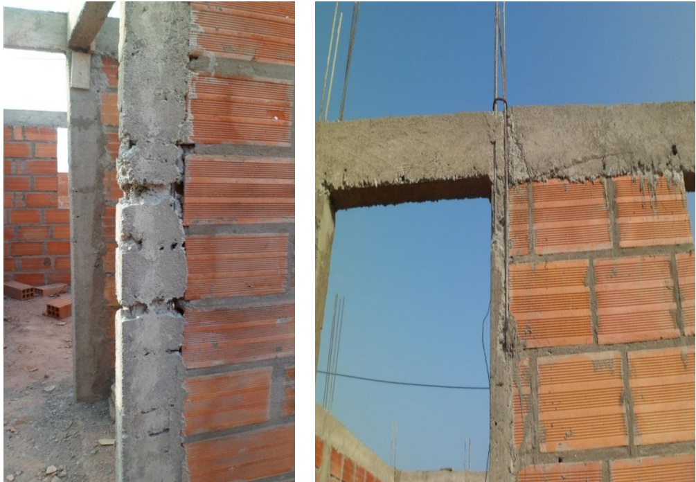
Figura 21. Segregación presentada en columnas
