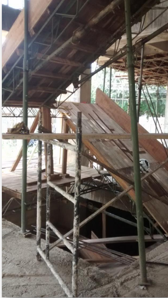
Ilustración 74 Plataforma para escaleras.
