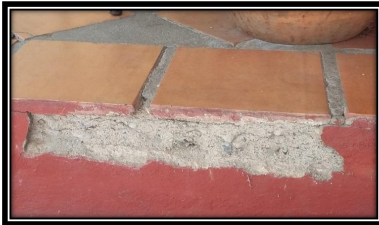
Descascaramiento en escalera
