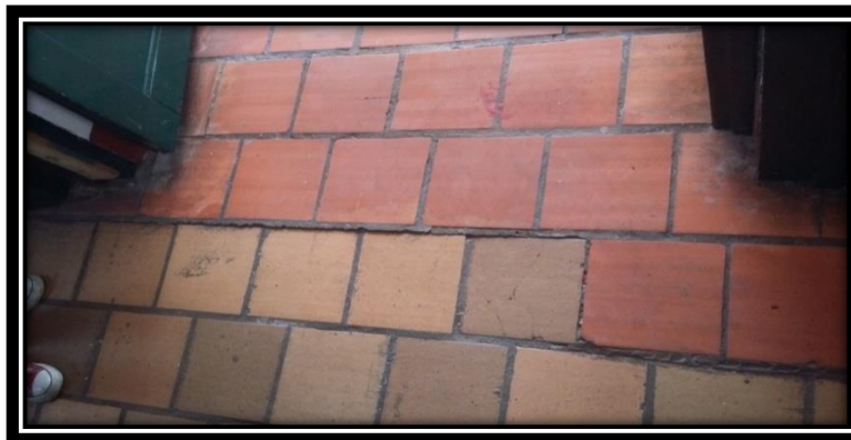
Fisura de piso oficina del estudiante
