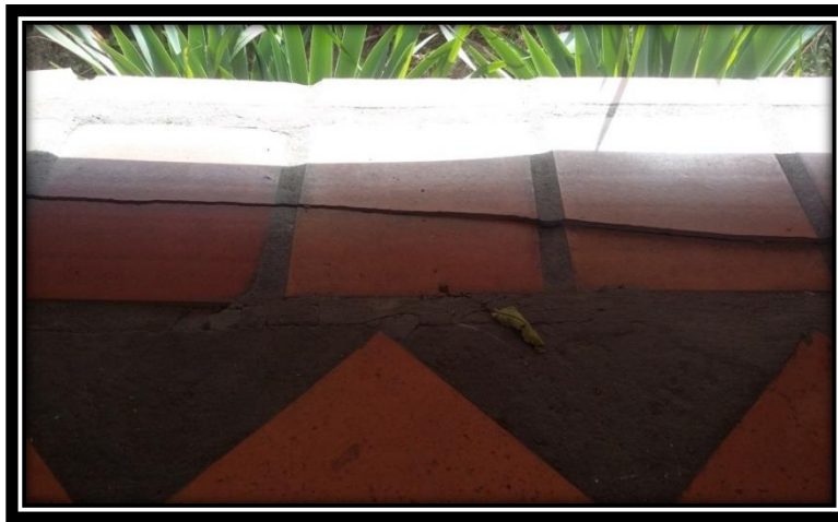
Fisura (piso oficina del estudiante)
