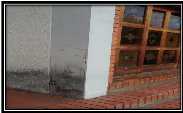
Fisura en columnas (oratorio)
