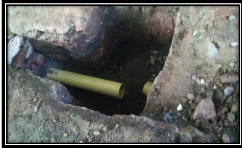
Caja de inspección
