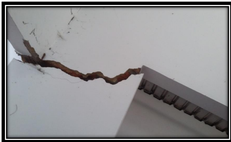
Grietas (lab. alimentos)
