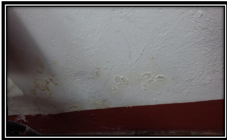
Descascaramiento por humedad
