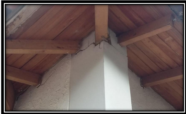
Fisuras en columna (oratorio)
