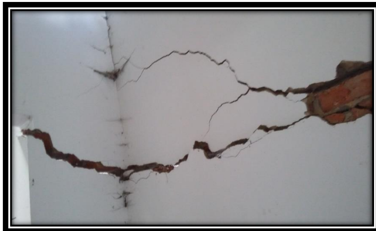
Grietas (lab. Alimentos)
