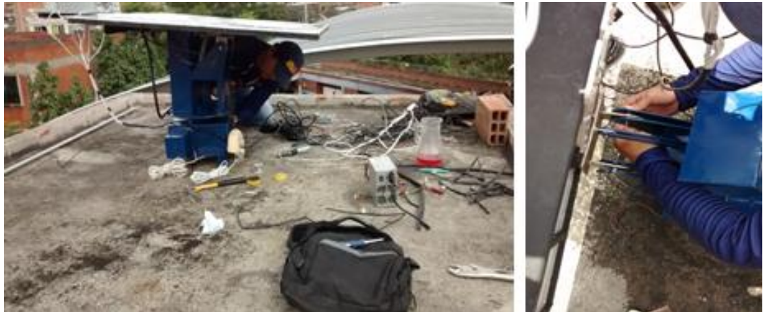
Figura. 24. Acople de estructuras y ubicación del sistema de seguimiento.
