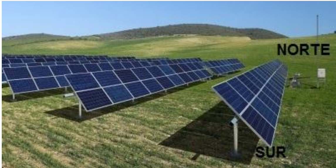
Figura. 17. Seguidor solar de un eje
