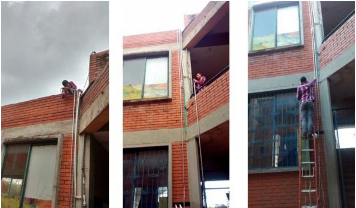
Figura. 30. Instalación eléctrica con tubos y cables según normas del RETIE
