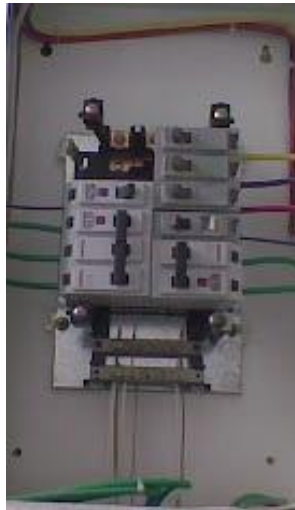
Figura. 9. Caja de conexión a la red eléctrica y protecciones
