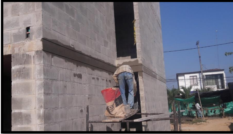
94 Dilataciones de fachada en bloque 5, torre 1 nivel 2. Fuente: Autor (2016)
