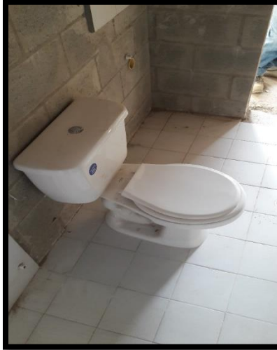
90 Sanitario instalado en el nivel 1 de la torre 4 del bloque 6 (baño adecuado para discapacitados). Fuente: Autor (2016)
