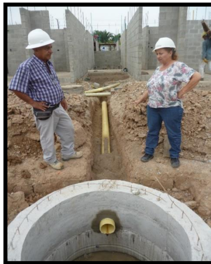
82 Colocación y empalme de tubería Novafort de 6" en pozo sanitario de bloque
