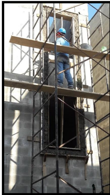
61 fundida en mortero de borde ventana bloque 6 Fuente. Autor (2016)
