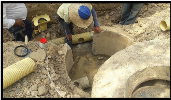
11 Abertura para la instalación de la silla Tee a la red de alcantarillado Fuente. Autor (2016)
