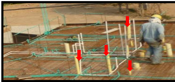
78 Puntos sanitarios de 2" en nivel 2, Aptos 1 y 2. Fuente: Autor (2016)
