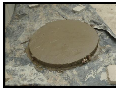
21 tapa de caja de inspección de aguas lluvia Fuente. Autor (2016)
