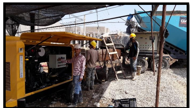
35 Bomba de concreto Fuente. Autor (2016)
