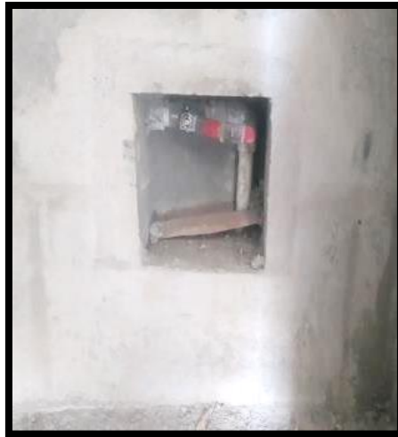
76 válvula de paso de 1/2" cocina Fuente. Autor (2016)
