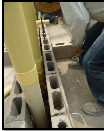
81 Tubería sanitaria de 4 " en buitrón sobre 2do nivel. Fuente: Autor (2016)
