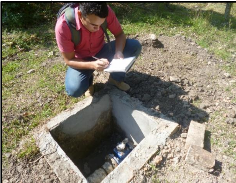
Figura 28. Macromedidores PTAP Acueducto San Andrés
