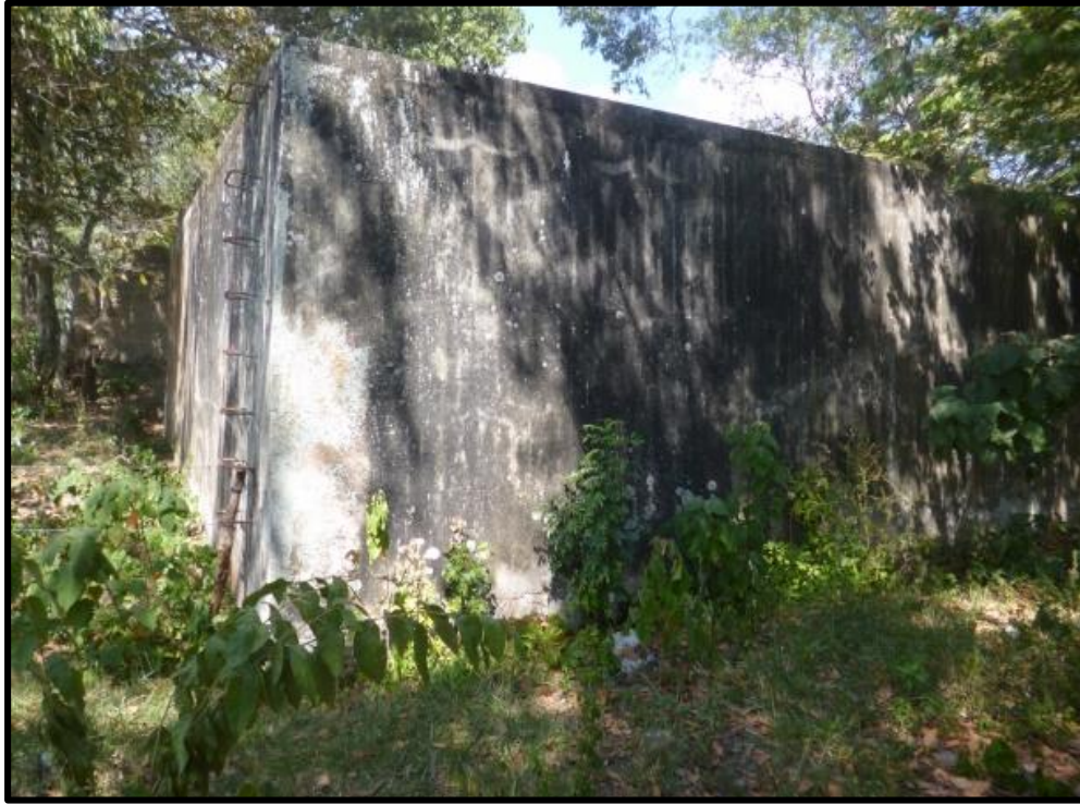
Figura 29. Tanque de Almacenamiento Acueducto San Andrés
