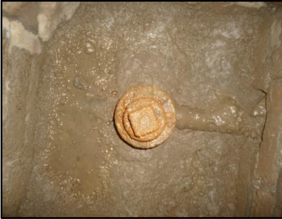
Figura 39. Interior de Válvulas San Andrés
