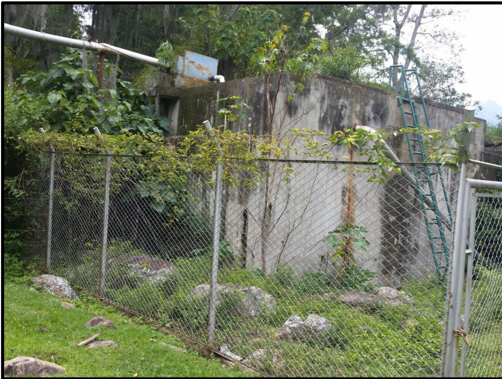
Figura 35. Tratamiento Secundario PTAR San Andrés
