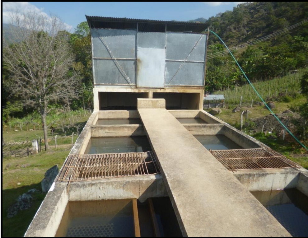
Figura 27. PTAP Acueducto San Andrés
