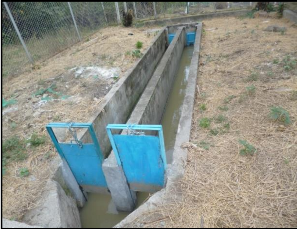
Figura 34. Pretratamiento PTAR San Andrés
