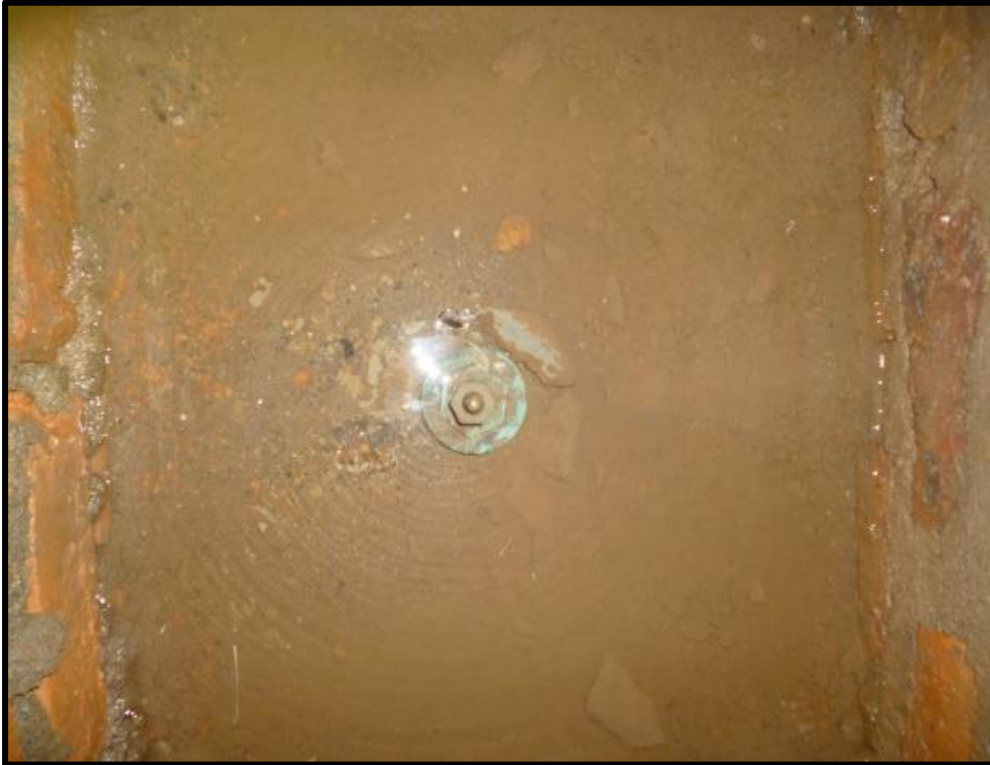
Figura 41. Válvula con Fuga San Andrés
