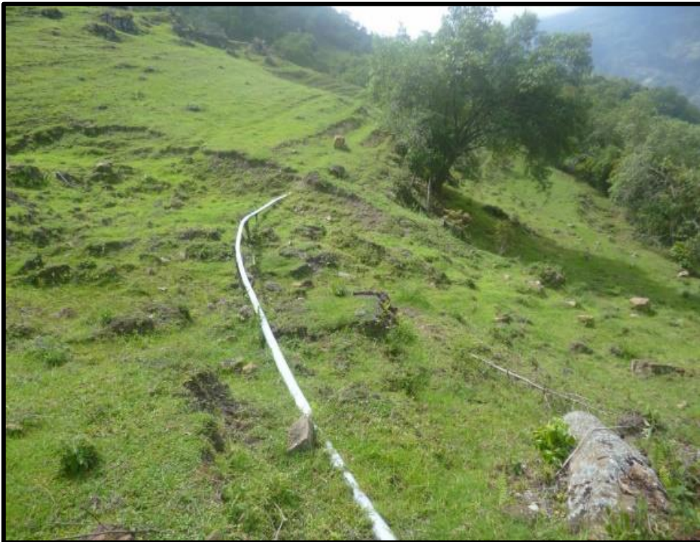
Figura 26. Aducción Acueducto San Andrés
