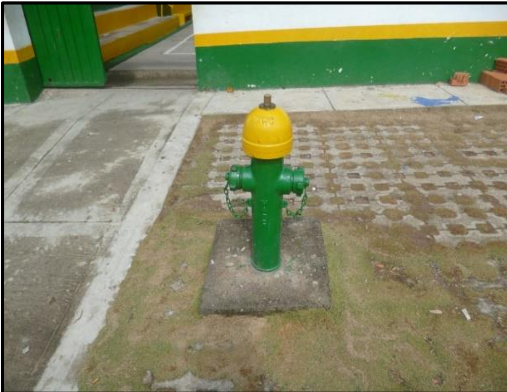
Figura 42. Hidrante San Andrés
