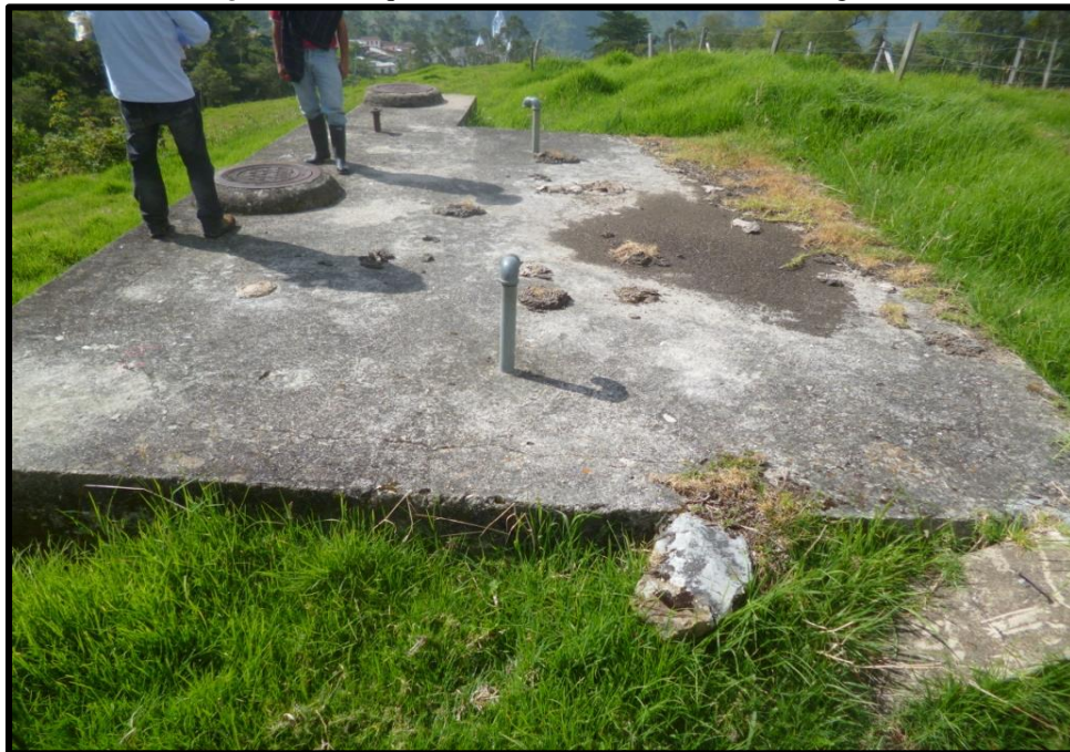
Figura 54. Tanque de Almacenamiento Existente Pangote
