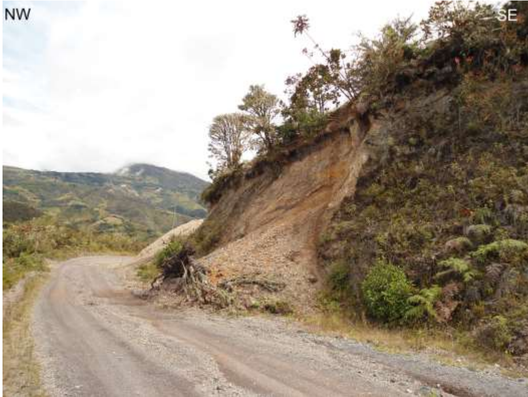
Fotografía 2. Deslizamientos sobre la vía a la zona de estudio.
