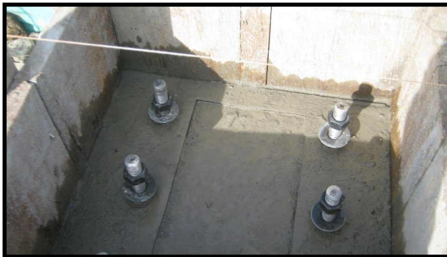
Figura 20. Columnas con los pernos de ajuste de los pedestales metálicos
