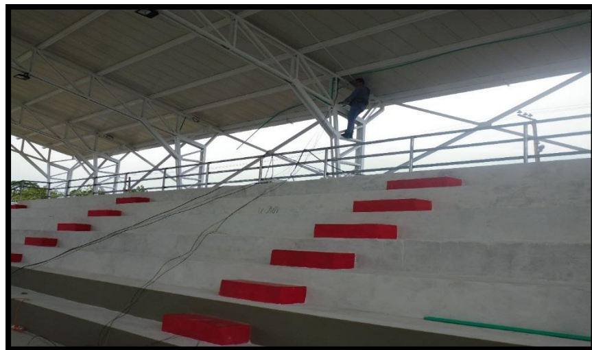
Figura 62. Cableado de alumbrado de cancha
