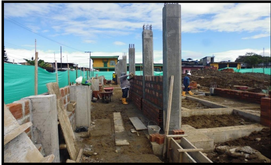
Figura 32. Pega de ladrillo en la parte trasera de la gradería
