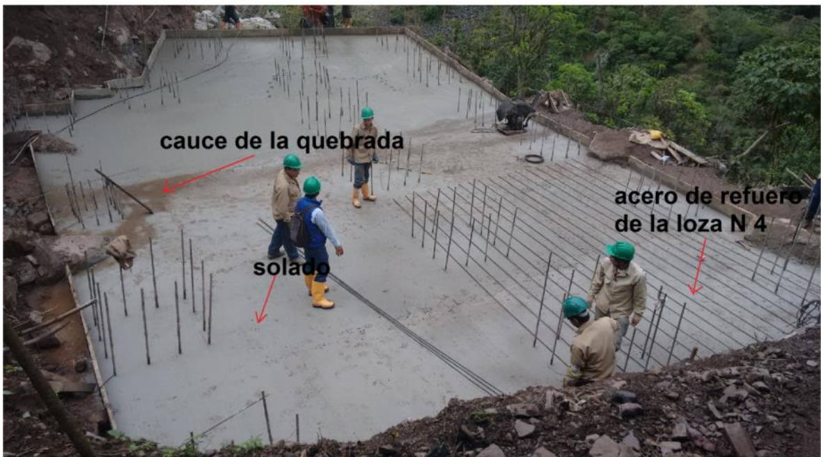
Figura 45. Recubrimiento del suelo con concreto pobre y extendido del acero de refuerzo.
