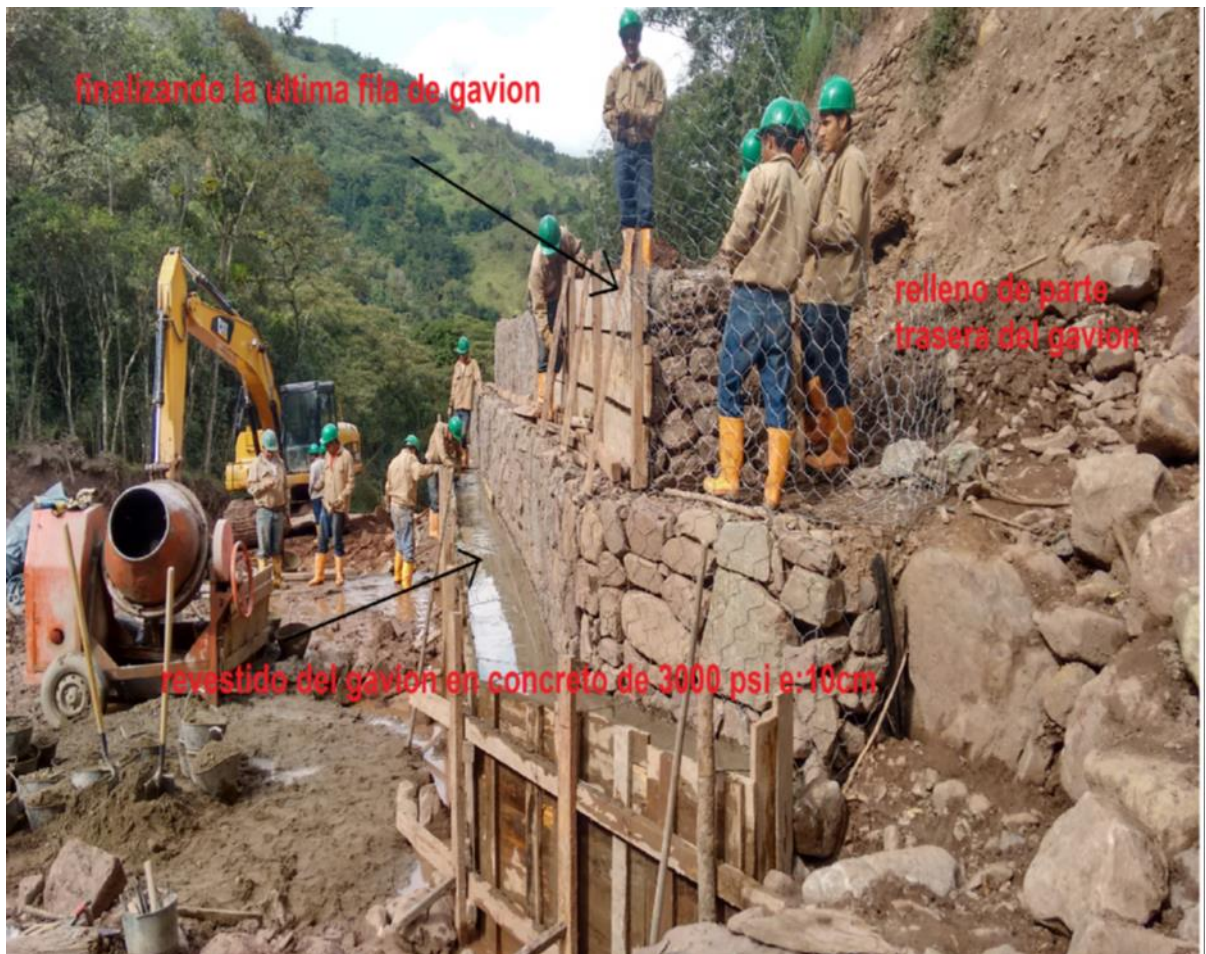
Figura 25. Revestido de gavión y relleno de su parte trasera.
