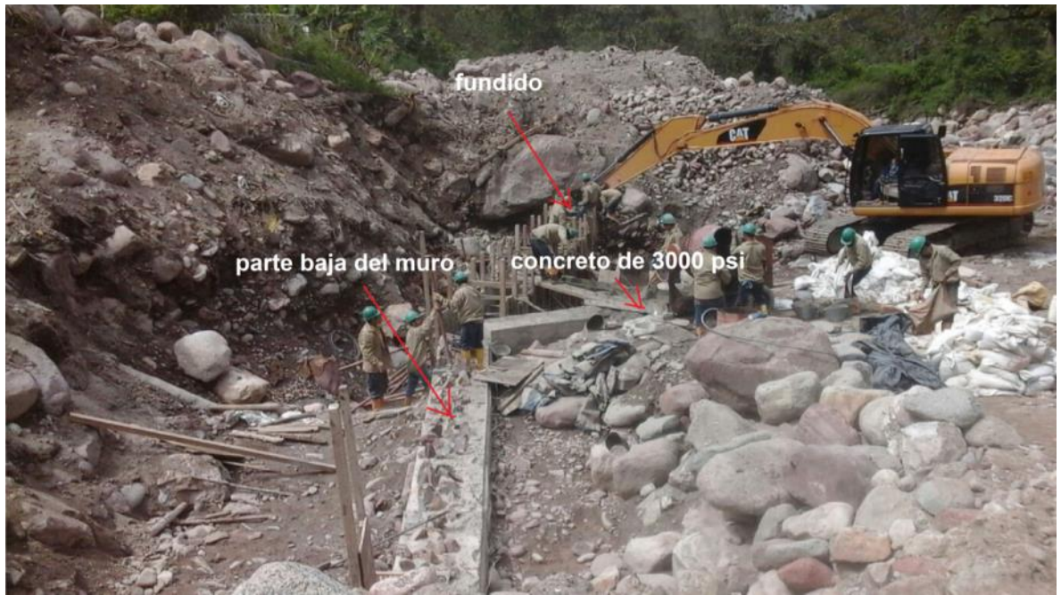
Figura 67. Fundido de la parte baja del muro.
