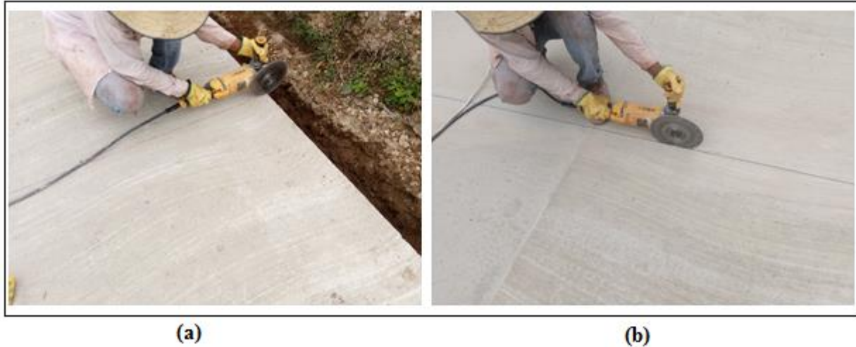
Imagen 17: Corte de dilatación para la estructura del pavimento.
