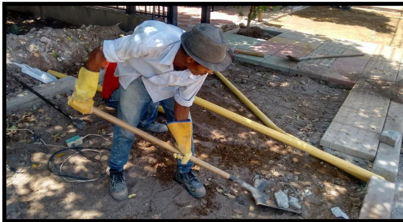
Figura 35. Tubería de desagüe
