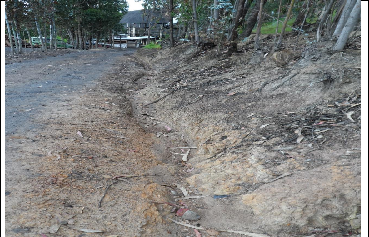
Fotografía 6. Zanjas de coronación
