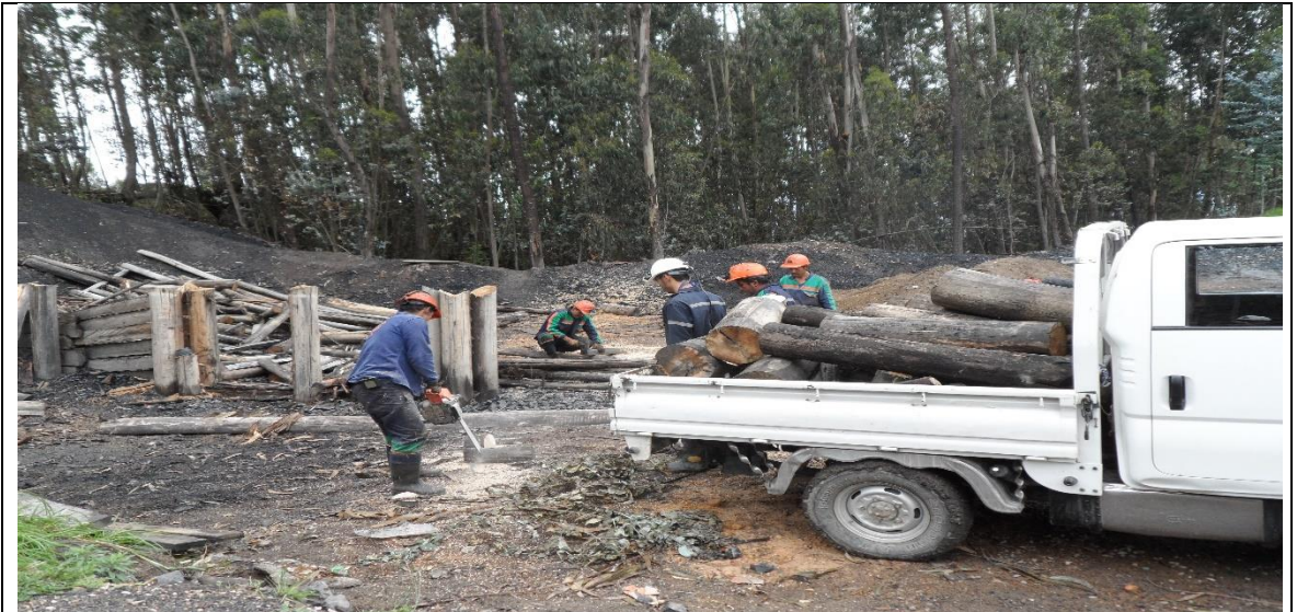
Fotografía 71. Selección de madera para usarlo en el proceso de mantenimiento en las bocaminas por parte de los trabajadores mineros
