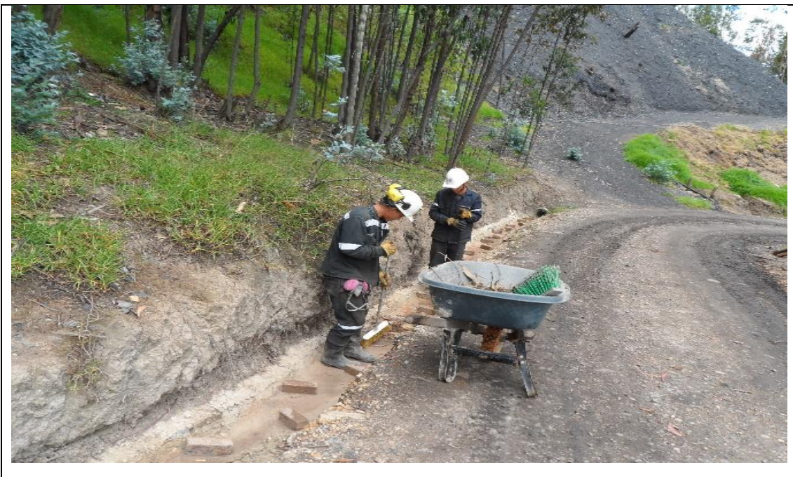
Fotografía 8. Disipador de energía
