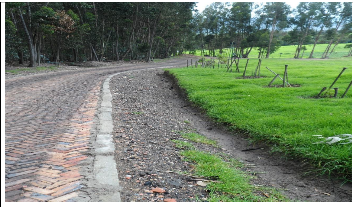
Fotografía 7. Cunetas en las vías de acceso
