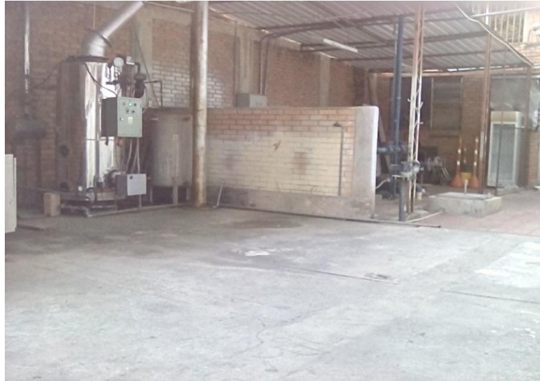
Imagen 15. Área de maquinas
