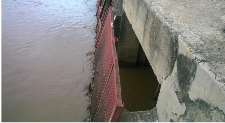
Imagen 9. Bocatoma del acueducto.
