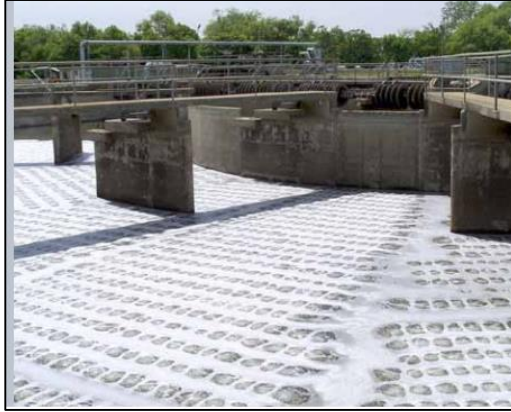
Figura 27. Instalación de difusores de aire Sanitaire. Fuente: (XYLEM, 2016).
