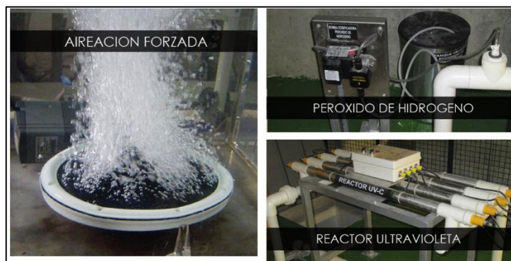
Figura 37. Equipos presentes en la oxidación Fuente: (NYFDECOLOMBIA, 2016)
