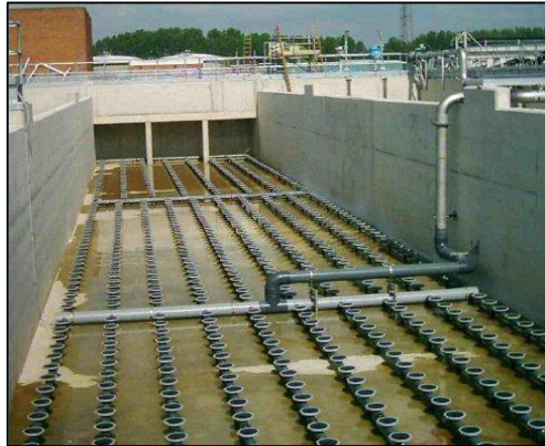
Figura 1. Difusores de un reactor biológico de lodos activados
