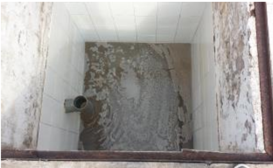
Imagen 5. Tanque séptico cámara 1
