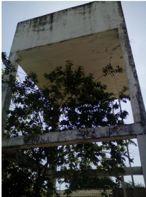
Imagen 3. Tanque de almacenamiento aéreo
